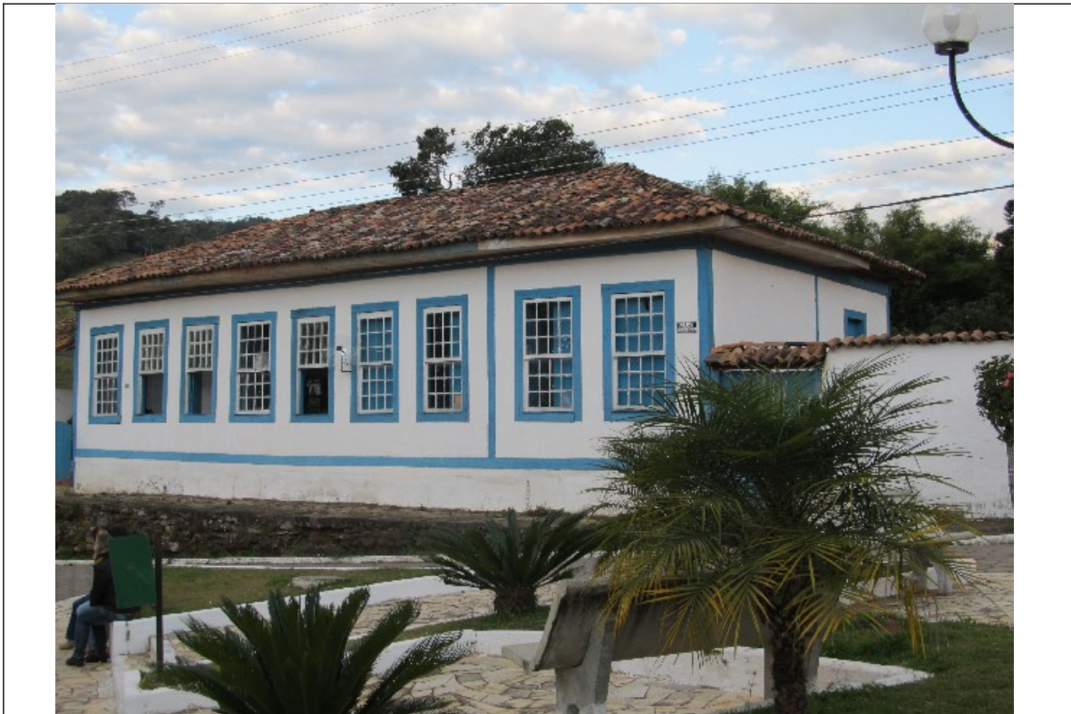
Figura 05- Casarão localizado na Praça Anísio Mendes da Fonseca, nº 68, em Alagoa. Foto da vistoria realizada em 24/07/2012.
