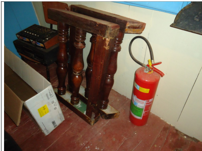
Figura 31 – Extintor em local inadequado.
