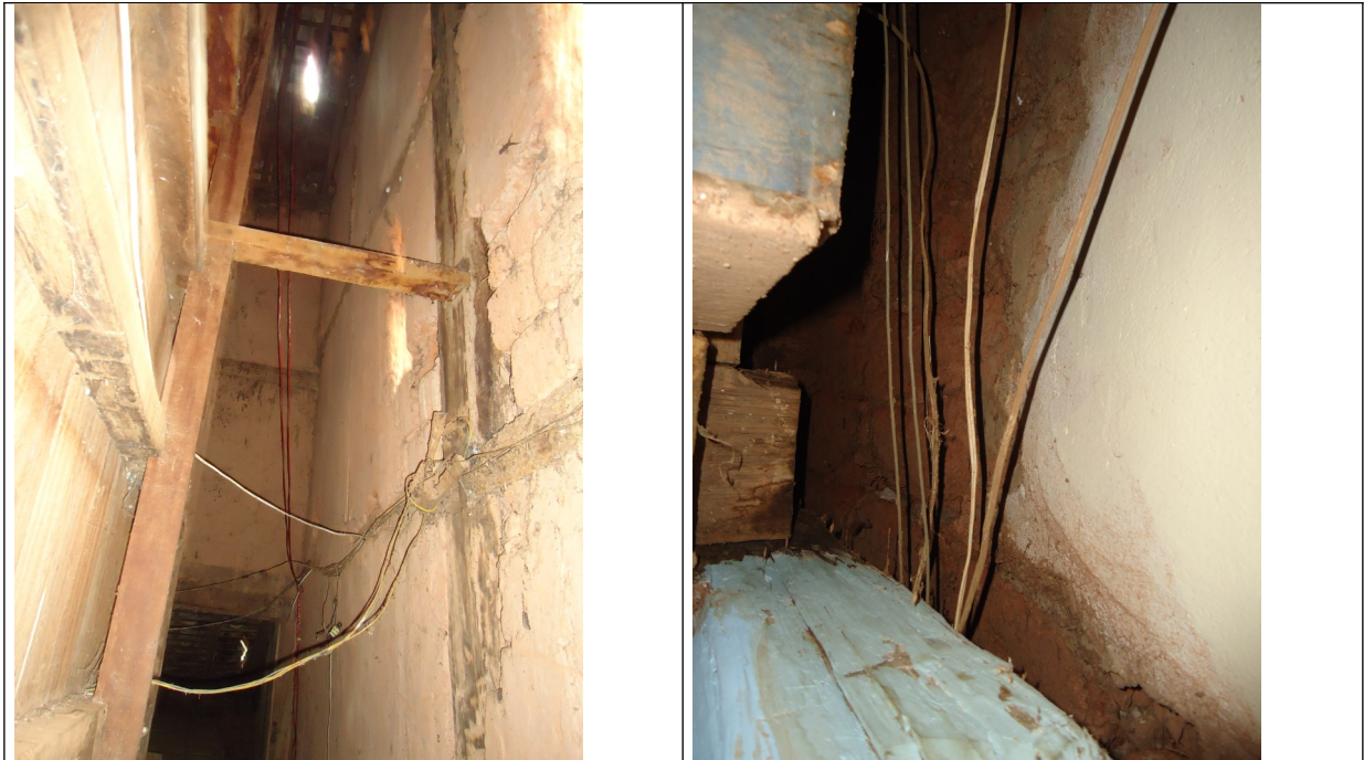
Figuras 29 e 30 – Fiação elétrica exposta, junto a elementos de madeira.
