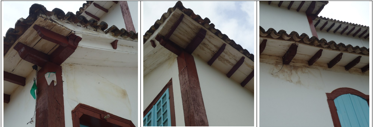
Figuras 14 a 16 – Manchas de umidade nas alvenarias e beirais.
