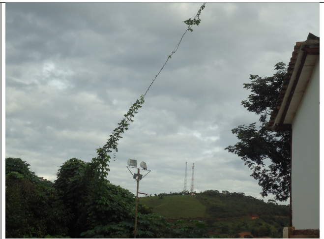
Figura 32 – Vegetação junto ao condutor de aterramento.
