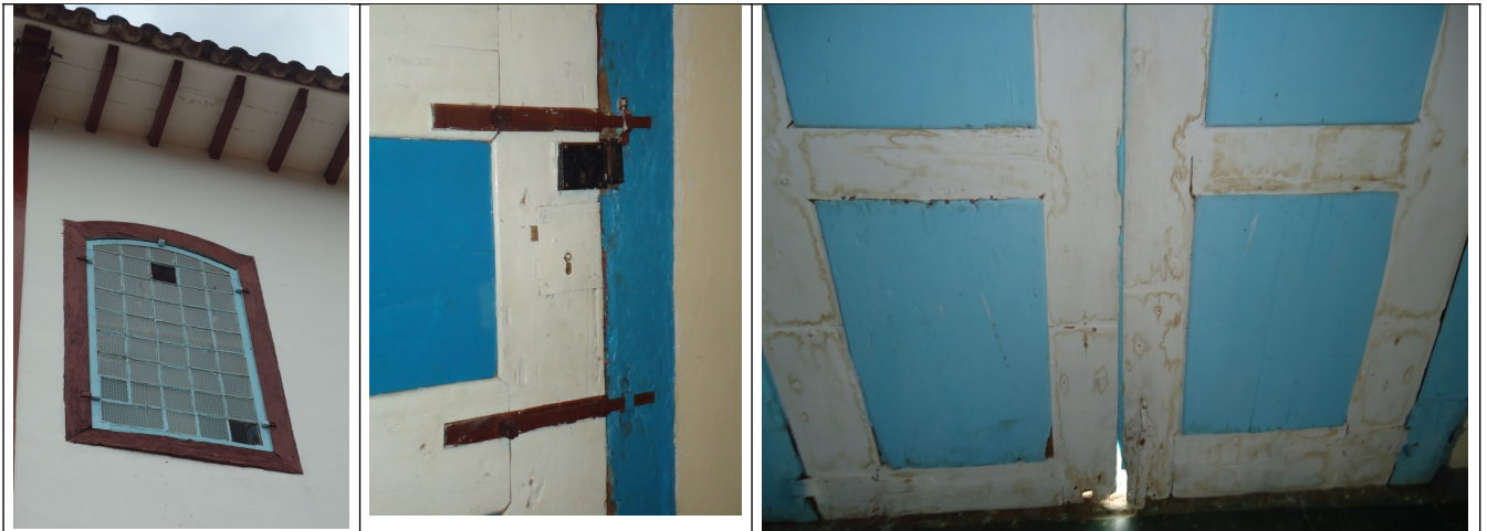
Figura 17 – Esquadria com vidros quebrados.
