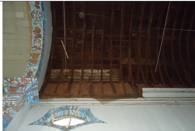
Figura 25 – Suporte do forro removido e cimalha faltante.
