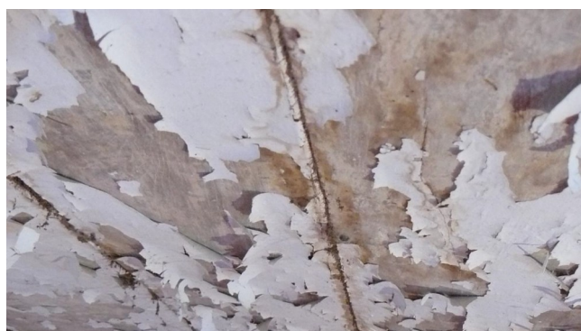
Figura 02 - Aspecto da camada pictórica em descolamento.
