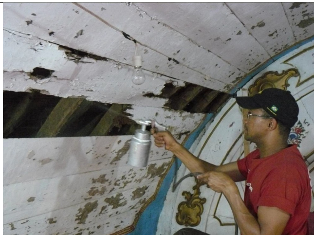
Figura 03 - Fixação da pintura em descolamento com aspersores.
