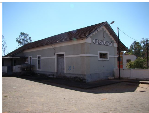
Figura 17 – Manchas de umidade junto ao piso externo.
