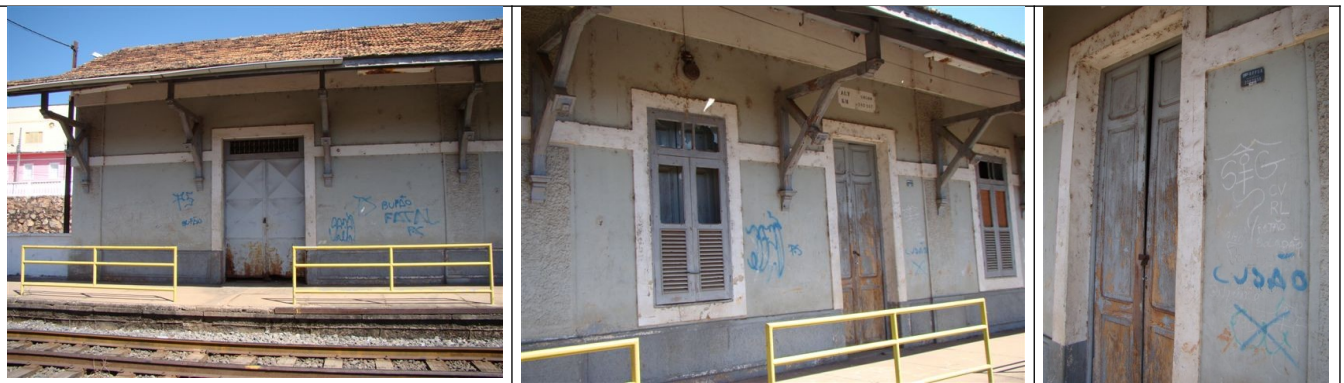
Figuras 07, 08 e 09 - Pichações e sujidades nas alvenarias.
