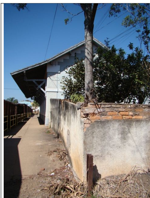
Figura 18 – Descolamento de reboco.
