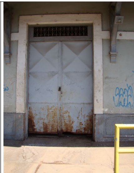
Figura 15 – Oxidação de esquadria.
