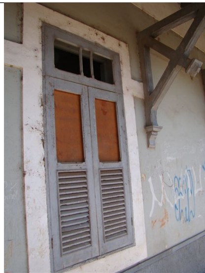
Figura 13 – Falta de vidros nas esquadrias.
