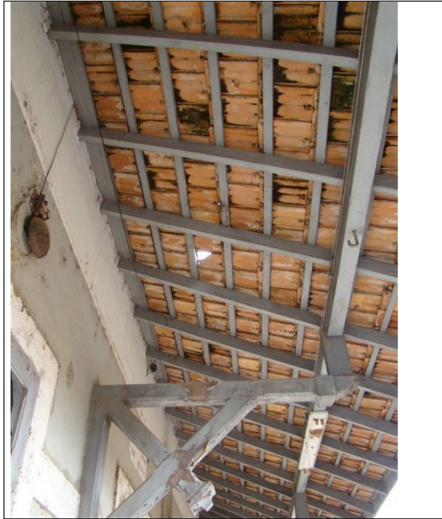
Figura 10 – Telhas quebradas na cobertura.
