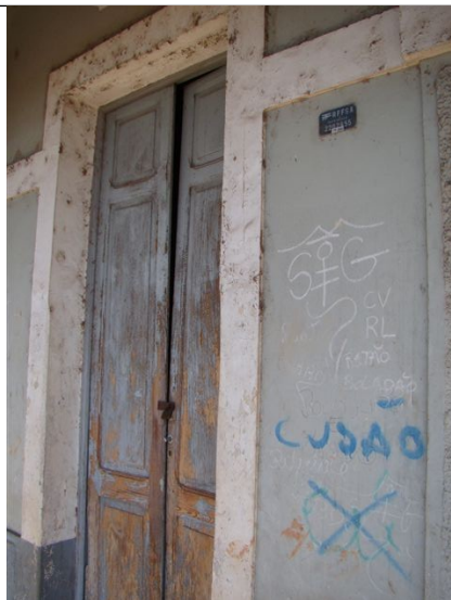
Figura 14 – esquadria em mau estado de conservação.
