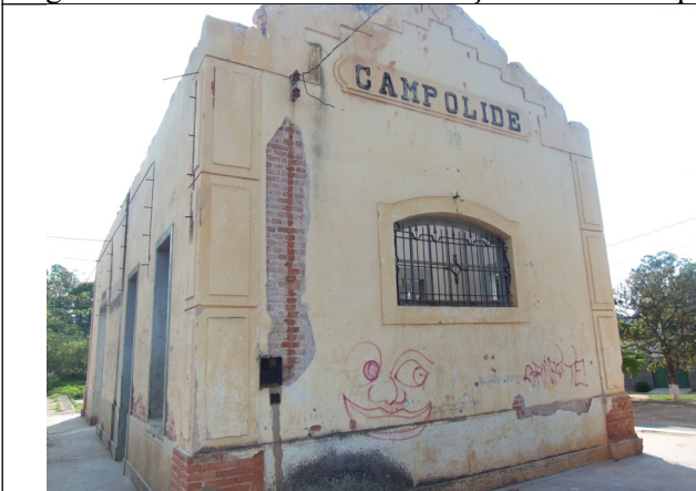
Figura 05 – Fachada lateral com descolamento de reboco, inscrições e manchas de umidade.
