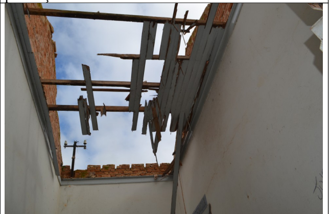
Figura 12 – Comprometimento do forro em madeira.
