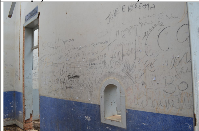
Figura 11 – Inscrições (vandalismo) na área interna da edificação.
