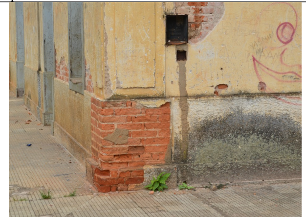
Figura 06 – Embasamento da fachada lateral com descolamento de reboco, inscrições e manchas de umidade.
