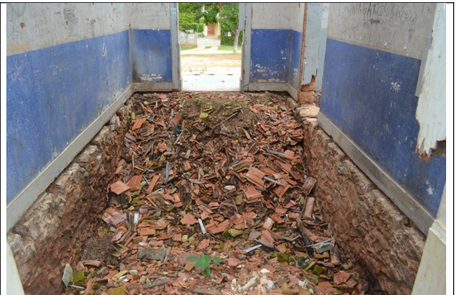
Figura 10 – Ausência do revestimento do piso e presença de entulhos.
