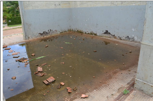
Figura 09 – Devido a ausência da cobertura, a água fica empoçada no interior da edificação.
