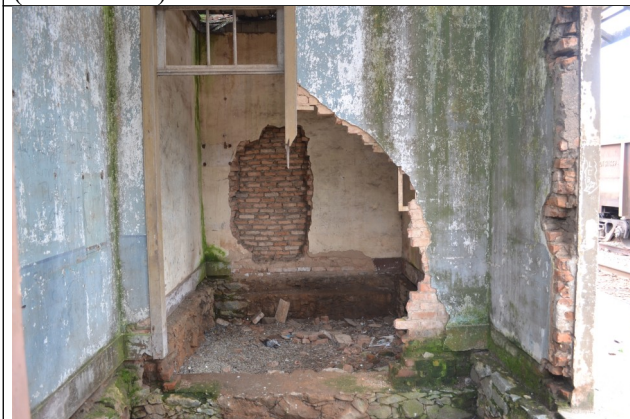
Figura 11 – Ausência do revestimento do piso, arruinamento de alvenarias na área interna da estação. Manchas de umidade nas alvenarias.
