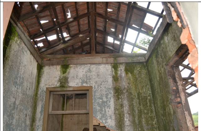
Figura 12 – Comprometimento da cobertura, ausência de forro e manchas de umidade nas alvenarias.
