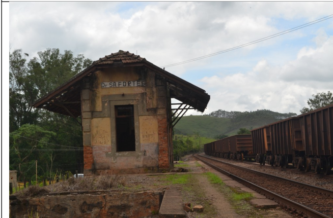
Figura 05 – Fachada lateral com descolamento de reboco, inscrições e manchas de umidade.
