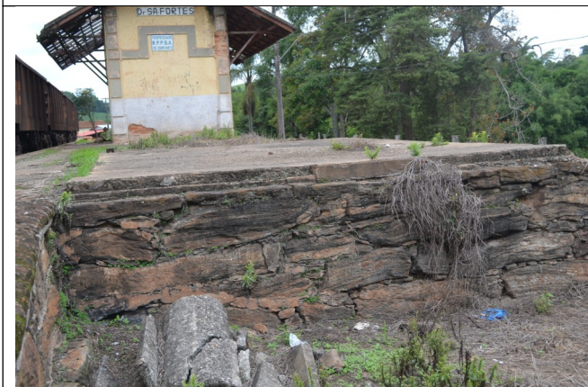
Figura 07 – Embasamento em pedras e plataforma em piso cimentado com vegetação invasora.
