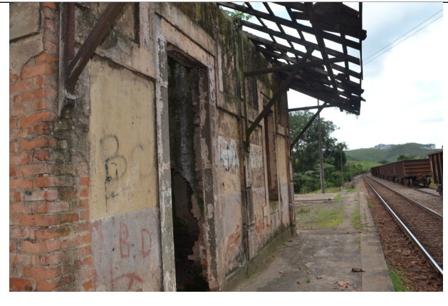
Figura 06 – Fachada frontal com danos na cobertura, descolamento de reboco, inscrições e manchas de umidade.
