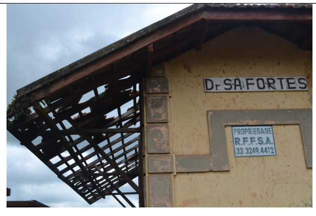
Figura 08 – Presença dos elementos decorativos e comprometimento da cobertura.
