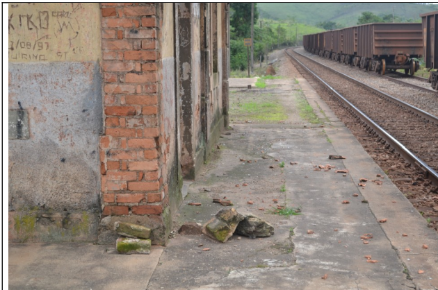
Figura 09 – Descolamento do reboco e inscrições (vandalismo) nas alvenarias..
