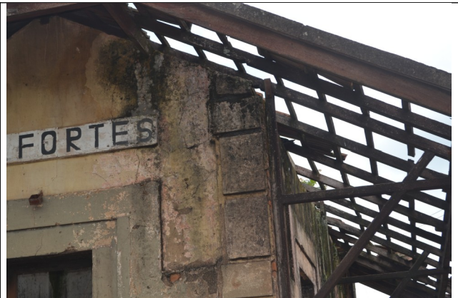
Figura 10 – Manchas de umidade nas alvenarias devido a ausência das telhas.
