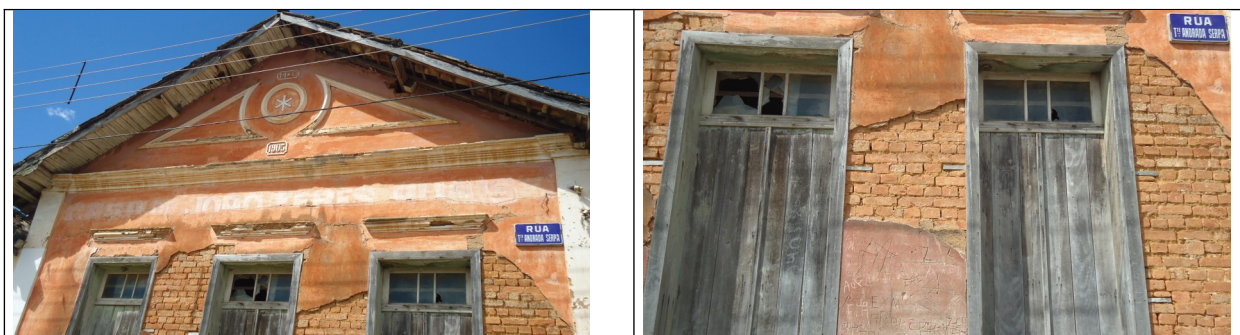
Figuras 05 e 06 – Descolamento do reboco e danos nas esquadrias.
