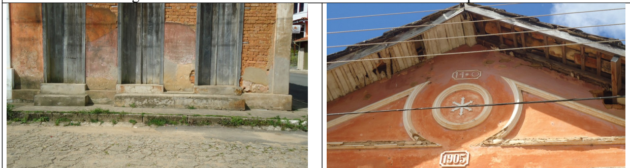
Figura 09 – Descolamento do reboco e danos nas esquadrias.
