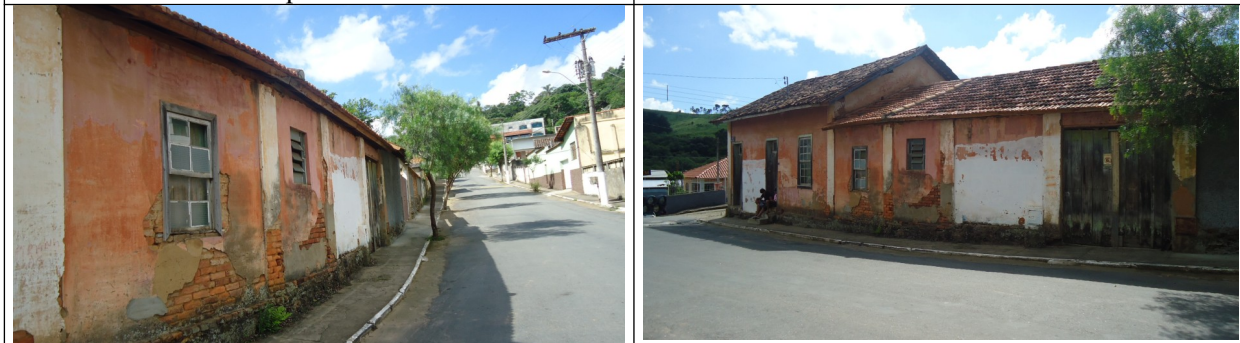
Figuras 11 e 12 – Fachada lateral com danos nas alvenarias.
