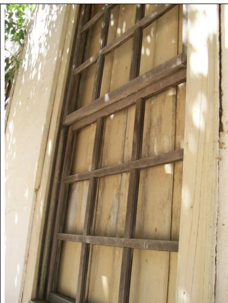
Figura 11 – Esquadrias sem vidros.
