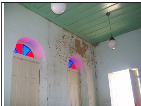
Figura 10 – Desprendimento de pintura devido à infiltração de água.
