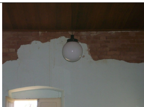
Figura 11 – Desprendimento do reboco devido a umidade.
