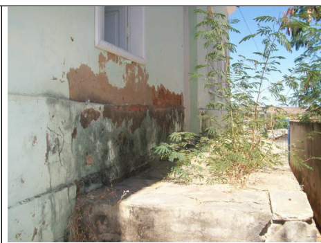
Figura 12 – Presença de vegetação junto à base da edificação e desprendimento de reboco.
