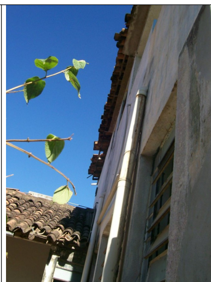
Figura 11 – Tubulação hidráulica exposta.
