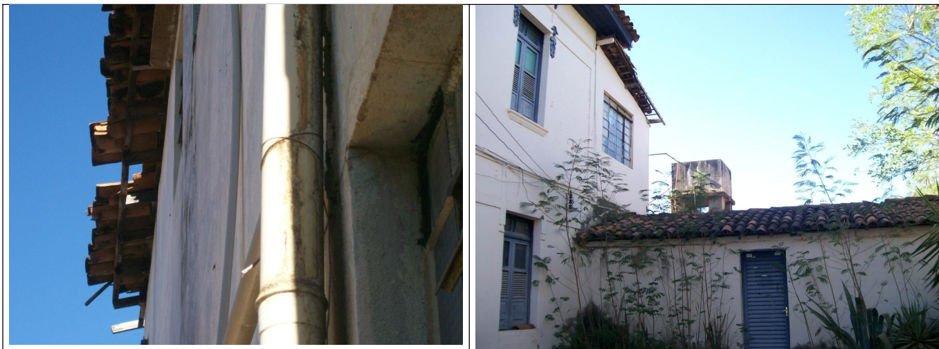
Figuras 12 e 13 – Cobertura danificada e acréscimo nos fundos e lateral.
