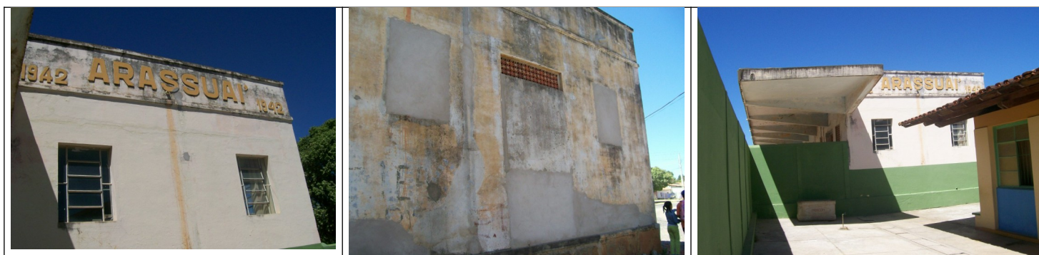
Figuras 10 a 12 – Fachadas laterais. Percebe-se na figura 06 a vedação dos vãos em alvenaria e as sujidades e manchas de umidade nas alvenarias.
