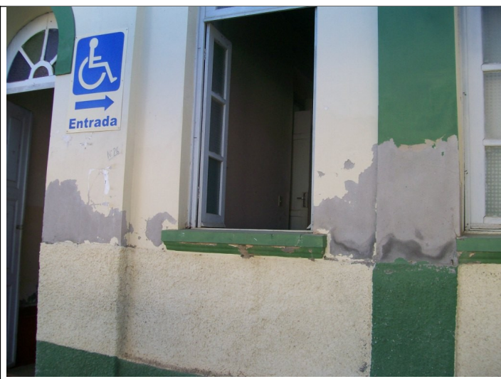
Figura 08 – Emendas em argamassa nas alvenarias.
