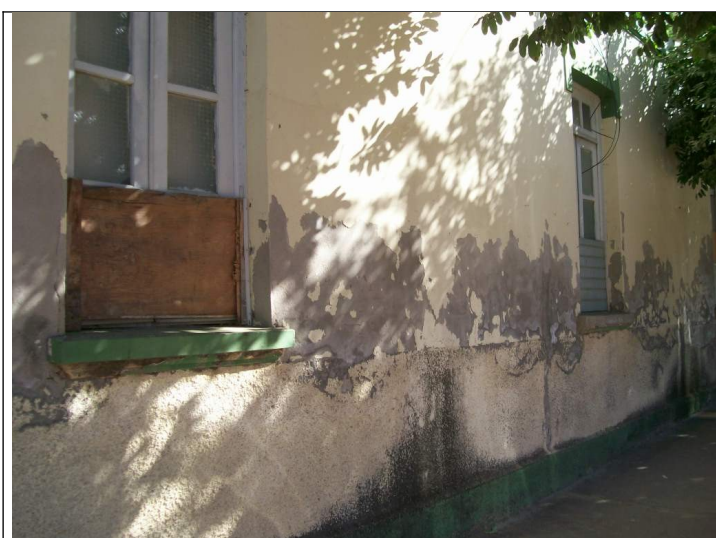
Figura 09 – Desprendimento de pintura devido à infiltração de água e descaracterização das esquadrias.
