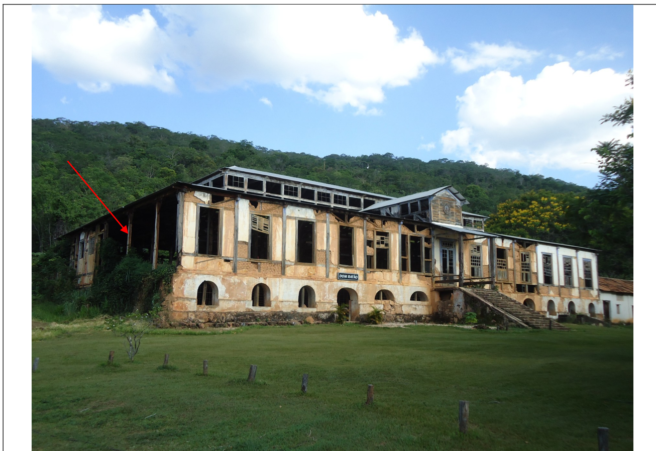
Figura 02 – Situação atual da antiga Companhia de Tecelagem Santa Bárbara. É possível perceber a perda das esquadrias e a parte que ruiu na fachada lateral esquerda coberta por vegetação invasiva (indicada pela seta vermelha).
