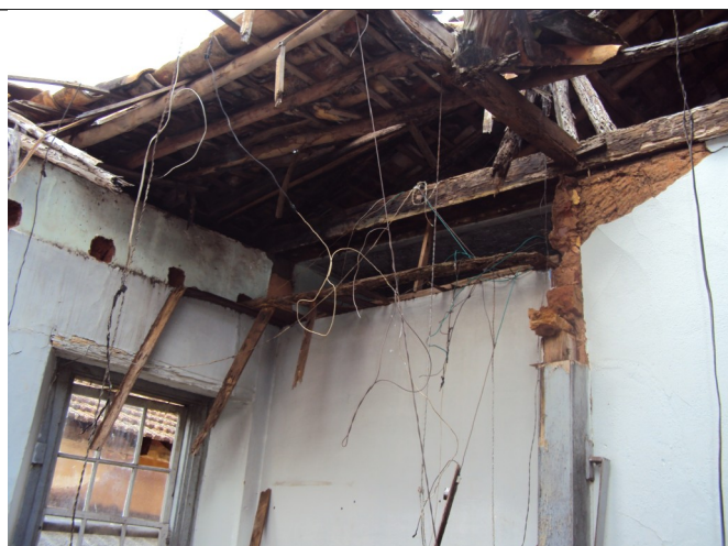
Figura 12 - Fiação exposta junto à umidade.
