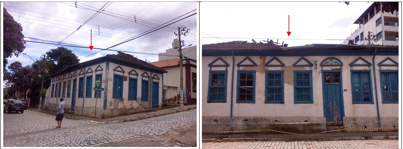
Figuras 03 e 04 – Situação atual do bem com parte do telhado que desabou – destacado pela seta vermelha.
