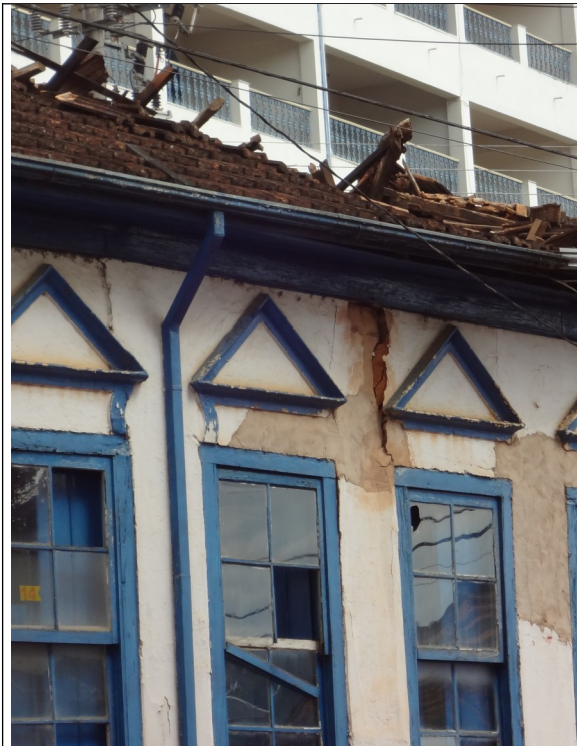
Figura 06 – Trinca em janeiro de 2013.
