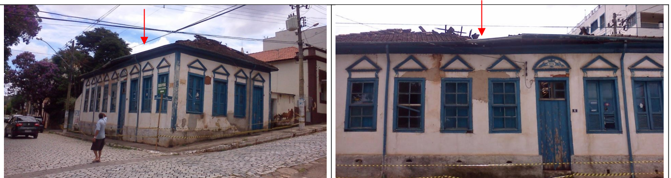
Figuras 03 e 04 – Imagens de janeiro de 2013, com o início do arruinamento da cobertura.
