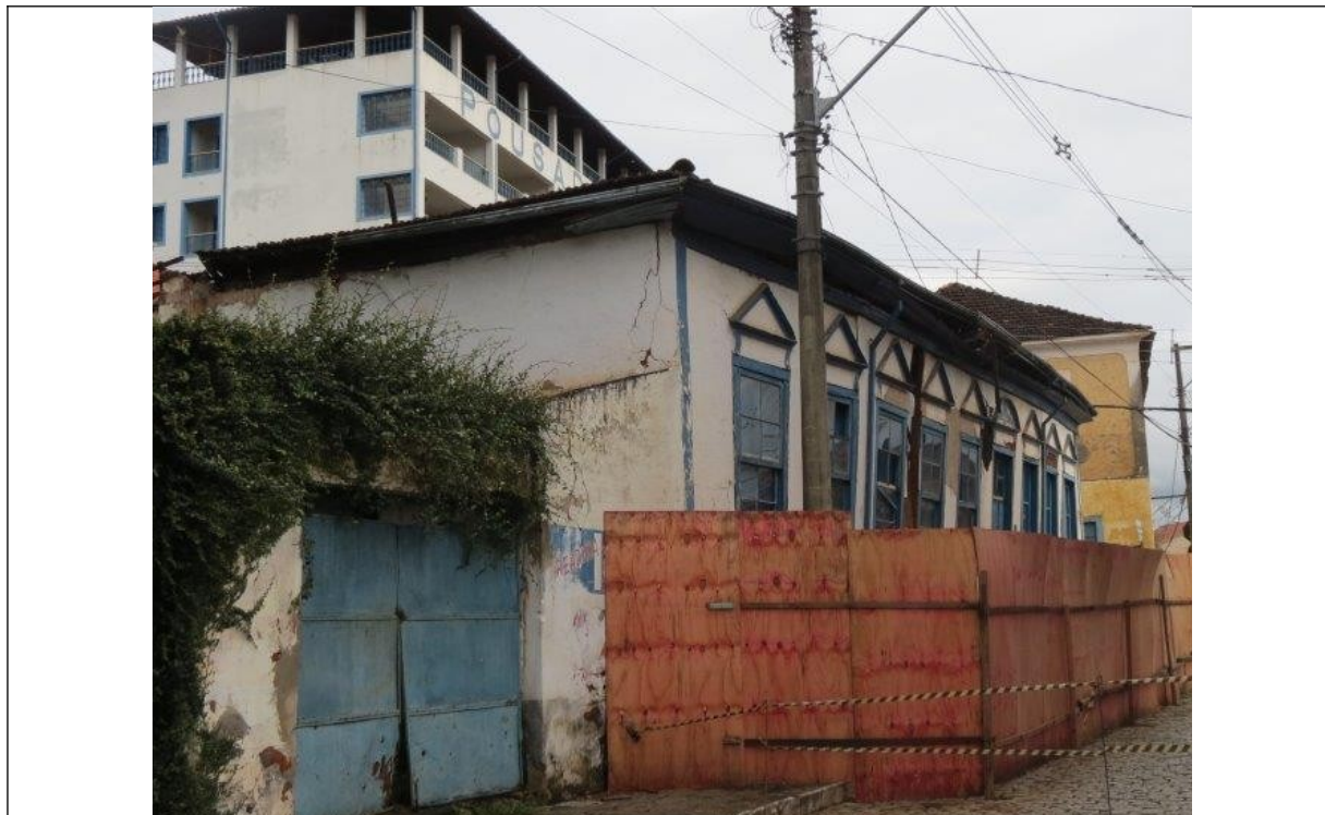
Figura 05 – Imagem de 05 de fevereiro de 2013 que demonstra a desestabilização da alvenaria frontal.
