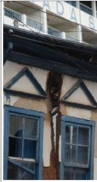
Figura 07 – Trinca em fevereiro de 2013.
