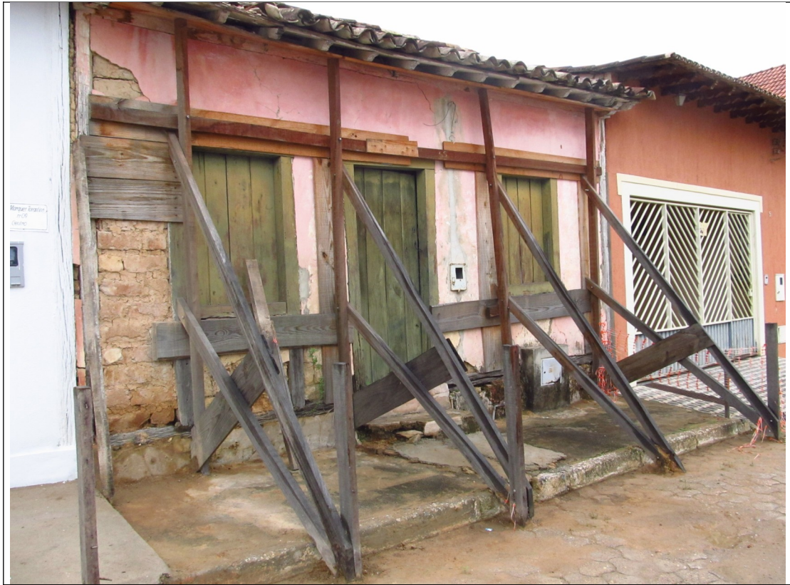
Figura 06 – Imagem de escoramento de fachadas. Fonte: Setor Técnico Promotoria Estadual de Defesa do patrimônio Cultural e Turístico de MG.
