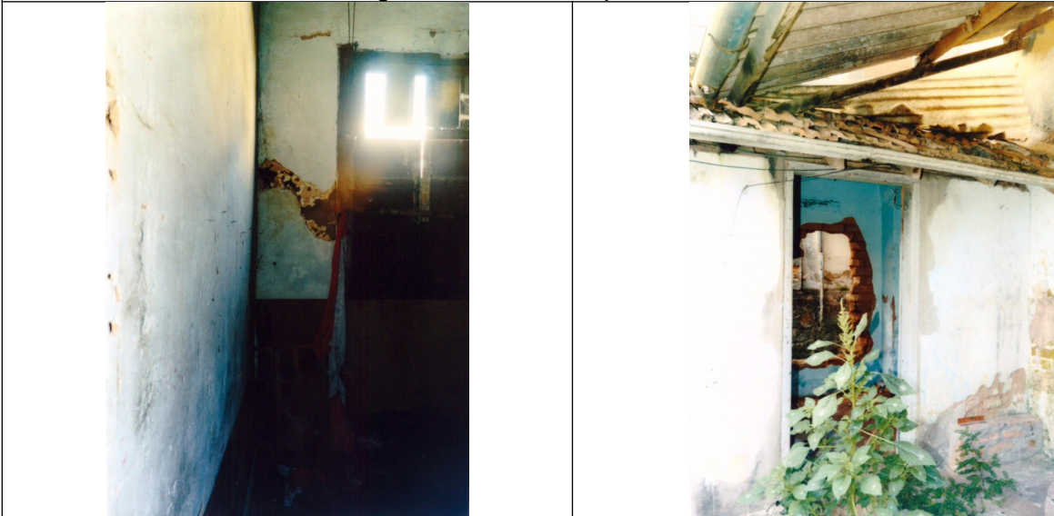
Figuras 10 e 11 – Situação atual das alvenarias.
