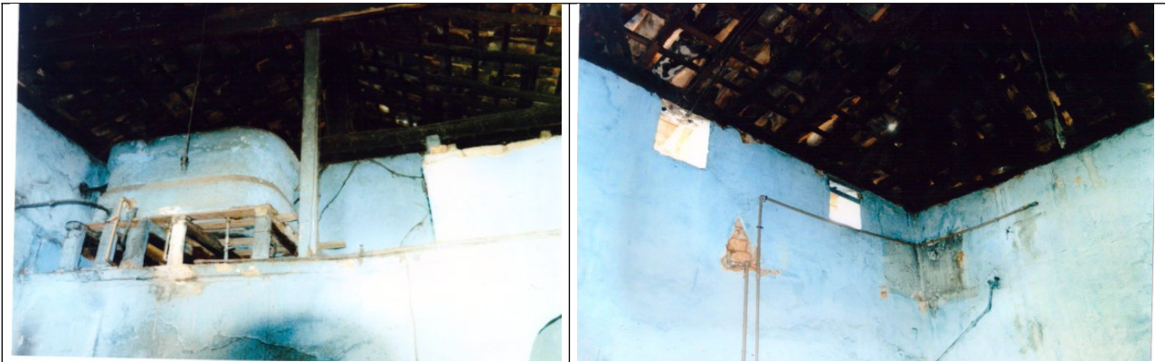
Figuras 08 e 09 – Situação atual do telhado.
