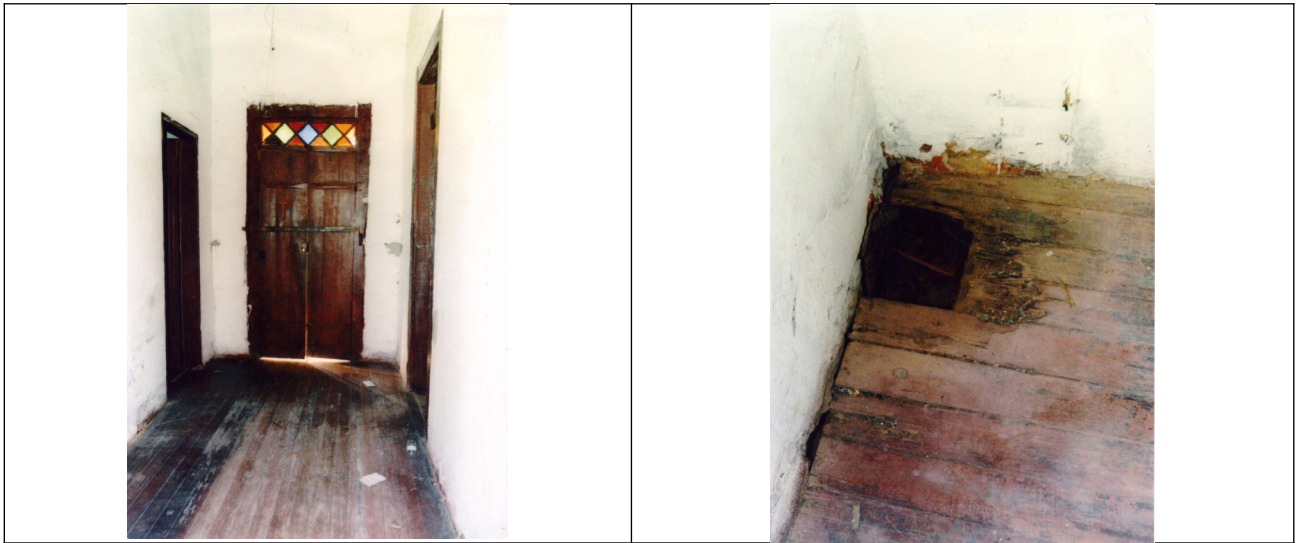
Figuras 13 e 14 – Situação atual do piso em tabuado.
