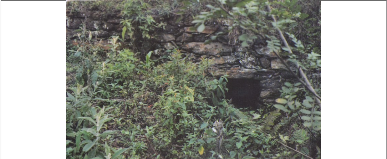
Figura 17- Boca de saída do aqueduto subterrâneo. Fotografia de 1991, pesquisada junto ao IEPHA.
