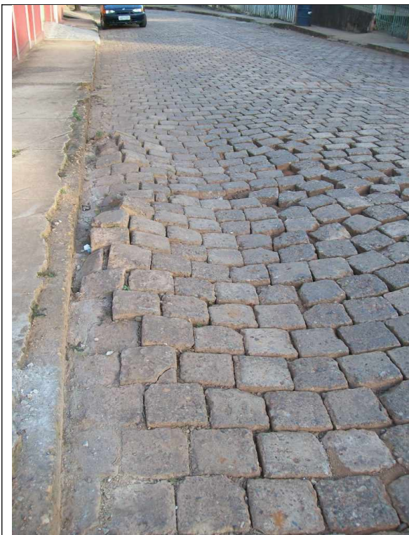
Foto 8 – Deformação verificada em via pública (Rua Afonso Pena).
