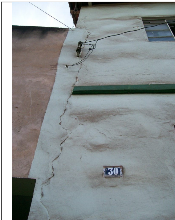
Foto 13 – Rachadura verificada em imóvel localizado à Rua Desembargador Moreira Santos.
