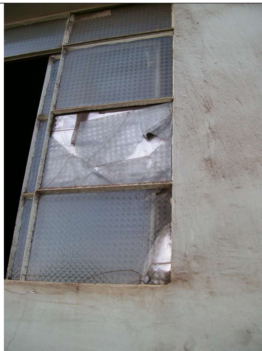
Foto 14 – Trincas verificadas em vidros de janela de imóvel localizado à Rua Desembargador Moreira Santos.
