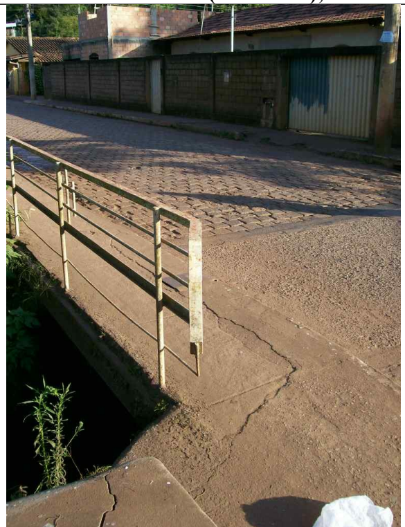
Foto 7 – Trinca verificada na pequena ponte existente na Rua Afonso Pena.
