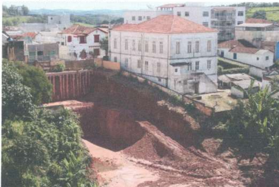
Figura 13: Foto mostra que a escavação ocorreu no final de 2014 após o laudo técnico pericial (cautelares) de meados de 2014.
