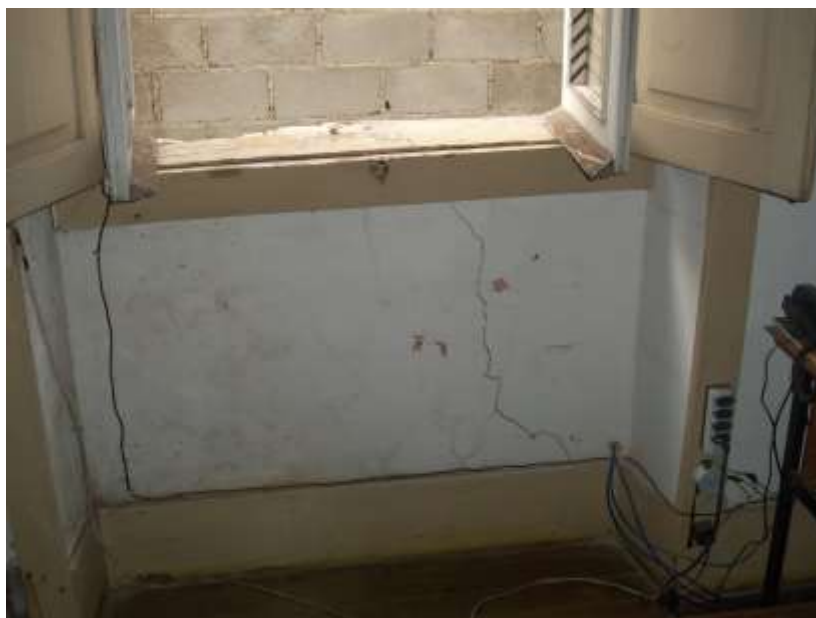
Figura 15: Rachadura de flexão na alvenaria pelo lado interno provocada pelo recalque da fundação.
