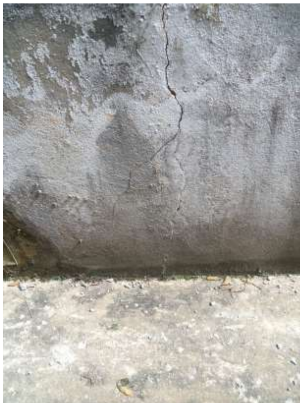
Figura 8: Nota-se que não há trinca no passeio, mas apenas na alvenaria que é decorrente de recalque da fundação.
