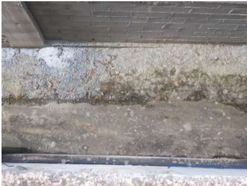
Figura 10: Nota-se que não há abatimento e nem trinca no passeio lateral, na divisa dos imóveis.
