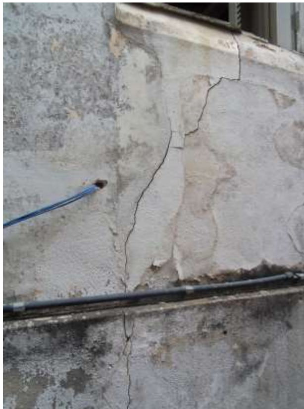
Figura 14: Rachadura de flexão na alvenaria pelo lado externo provocada pelo recalque da fundação.
