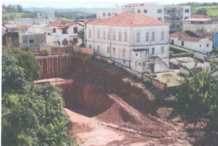
Figura 3: Escavação executada à direita do Solar dos Bias no imóvel de propriedade da empresa Mantiqueira Locações & Transportes Barbacena. Fonte: Notificação extrajudicial, fl. 05 dos autos.
