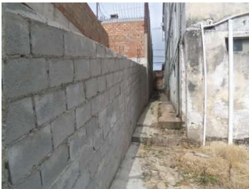
Figura 5: Passeio lateral no imóvel do Solar dos Bias, na divisa com a obra. Nota-se muro de blocos de concreto executado no local.
