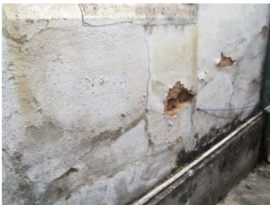
Figura 9: Nota-se que não há trinca na base da base parede proveniente do passeio lateral o qual não apresentou abatimento, nem trincas e fissuras.
