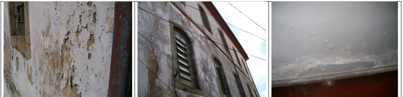
Figuras 13 e 14 – Patologias no reboco e pintura.
