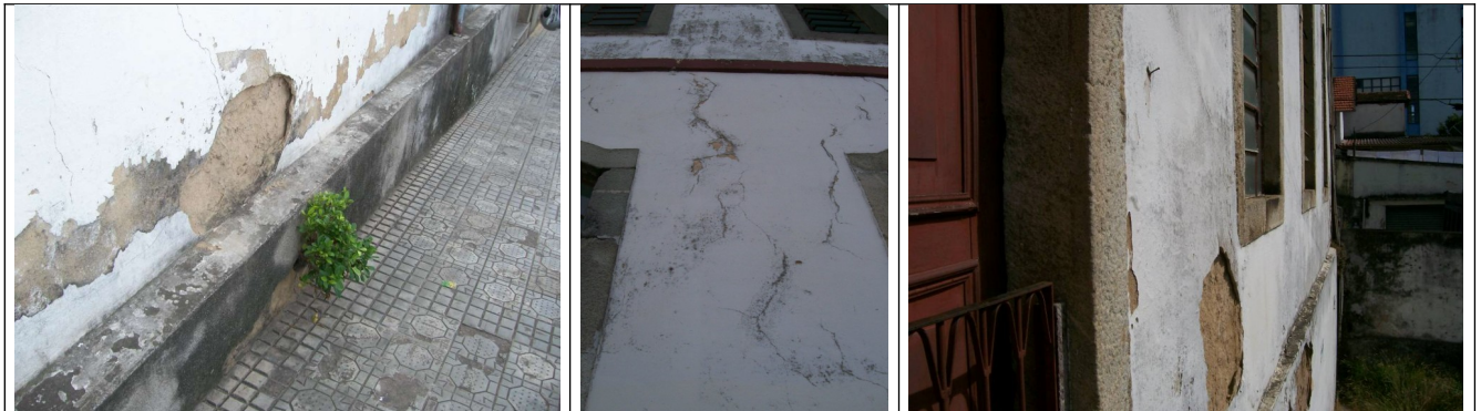
Figuras 10, 11 e 12 – Trincas e descolamento do reboco.
