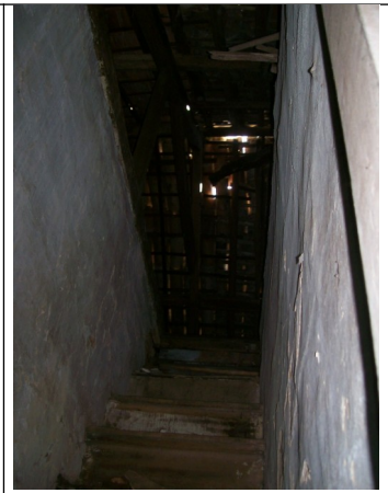
Figura 19 – Vista interna do telhado, com telhas quebradas e escorridas.
