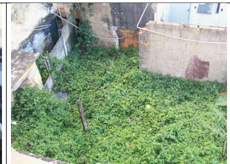
Figura 22 – Mato nos fundos da edificação.
