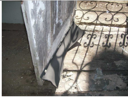
Figura 24 – Esquadria com madeira apodrecida.
