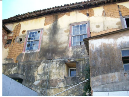
Figura 15 – Manchas de umidade e desprendimento do reboco.
