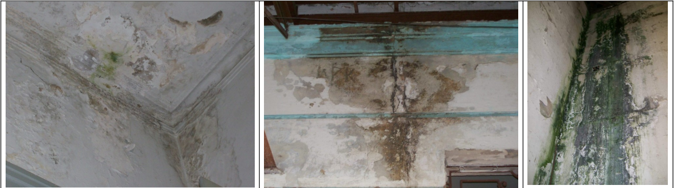
Figuras 21 a 23 – Presença de umidade.
