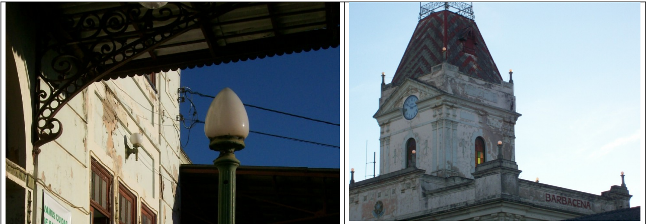
Figuras 27 e 28 – Alvenarias com manchas de umidade e descolamento de pintura.
