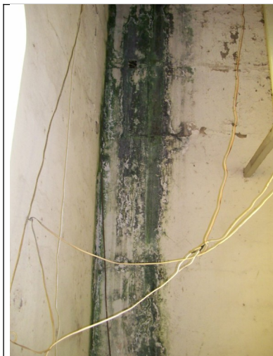
Figura 24 – Fiação exposta junto à umidade
