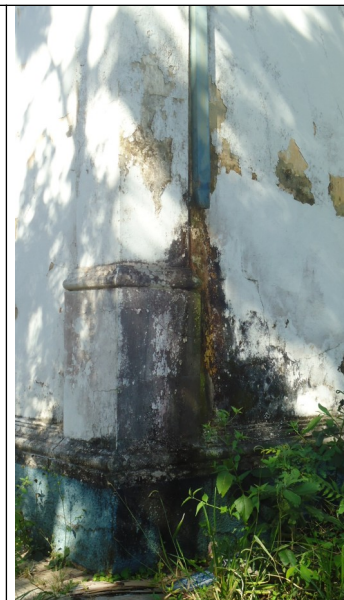
Figura 12 – Umidade nas alvenarias.
