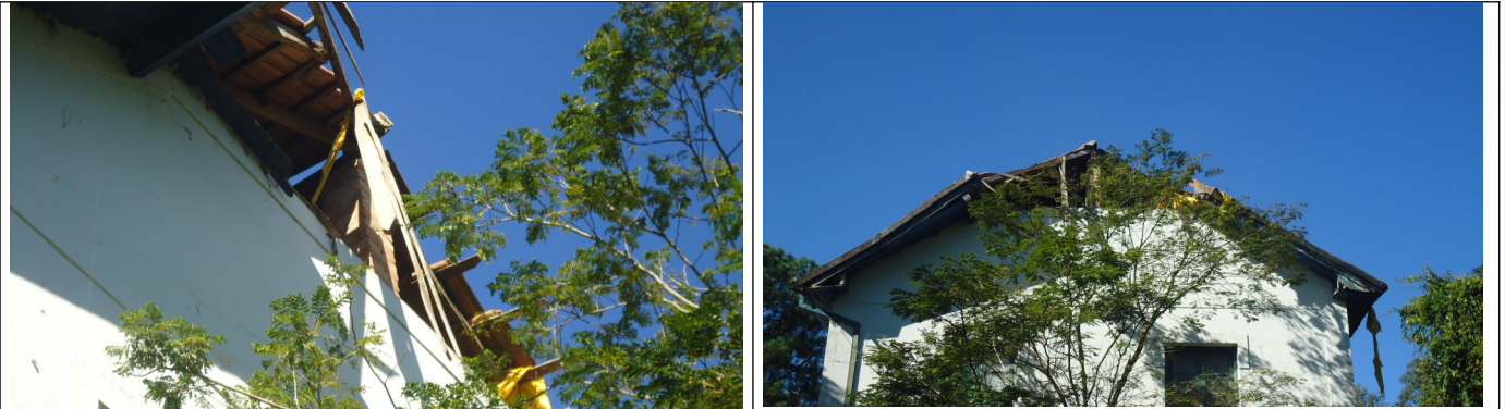
Figuras 09 e 10 – Trecho da cobertura que desabou.
