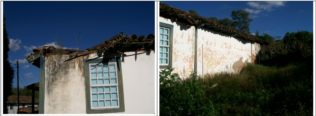
Figura 13 e 14 – Edificação em processo de arruinamento.
