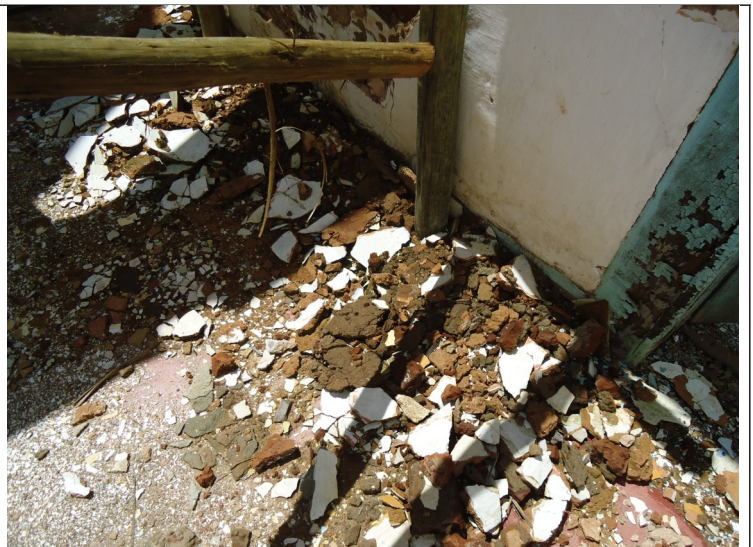
Figura 15 – Descolamento do reboco..
