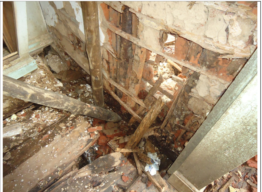
Figura 11 – Danos no interior do imóvel.
