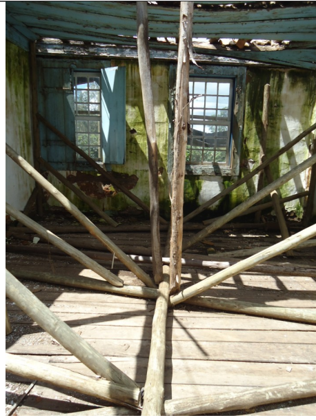
Figura 08 – Imagem interna da edificação onde se observa a degradação dos acabamentos originais do forro, alvenarias e piso.
