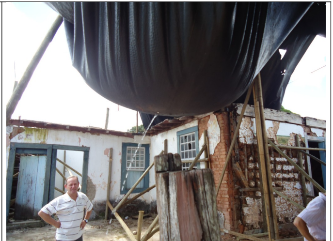
Figura 17 – Acúmulo de água na lona.
