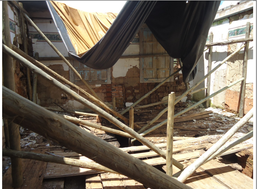
Figura 09 – Imagem interna onde se observa a água empoçada sobre a lona pesando causando sobrepeso nos forros e alvenarias remanescentes.
