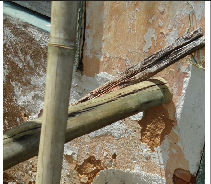
Figura 13 – Estaca apoiada diretamente na alvenaria.
