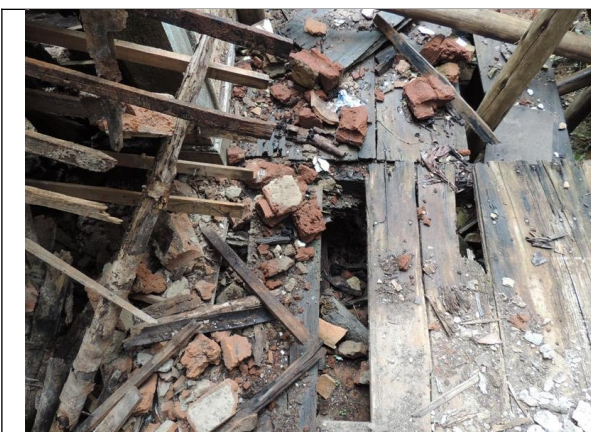
Figura 05 – Estrutura de madeira do piso totalmente deteriorada.
