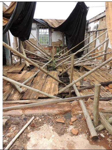
Figura 08 – Escoramento com lonamento antigo deteriorado – vista interna.
