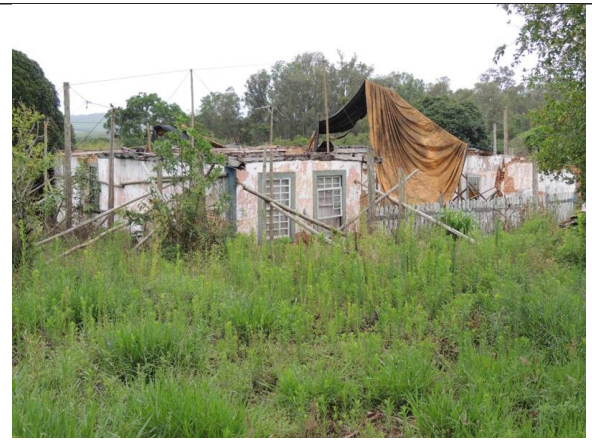
Figura 02 – Vista do imóvel com o lonamento antigo deteriorado.
