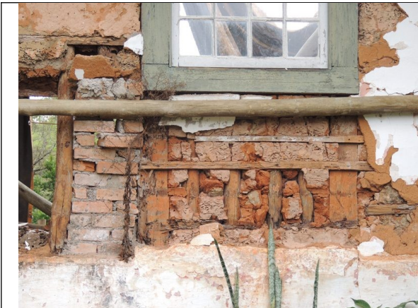
Figura 03 – Estrutura de madeira e alvenaria de barro exposta às intempéries.
