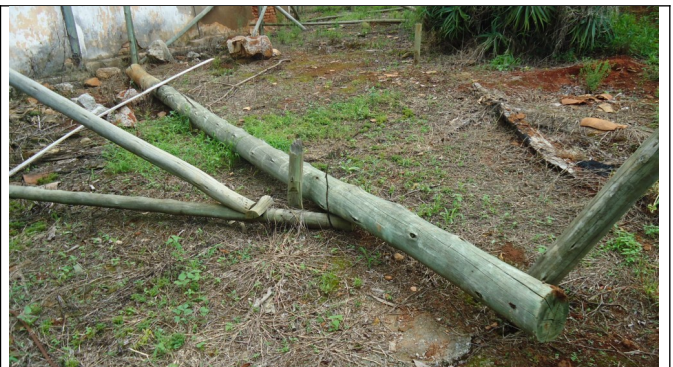
Figura 20 – peças soltas do escoramento.
