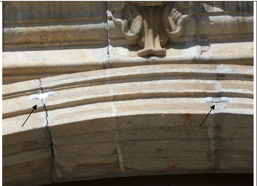
Figura 08 – Trincas na cantaria de pedra e existência de “testemunhos” (setas).
