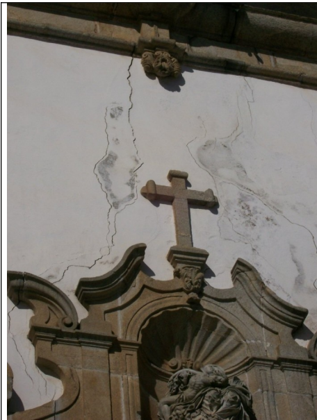
Figura 07 – Trincas no frontispício.
