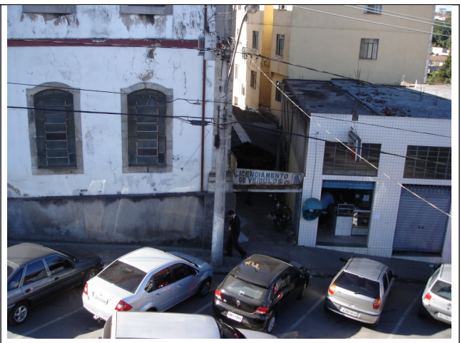
Figura 13 - Edificação comercial à rua General Câmara nº 29 – trecho frontal onde pode-se perceber as esperas e prédio de apartamentos nos fundos. Fotografia da vistoria deste setor técnico em junho de 2010.
