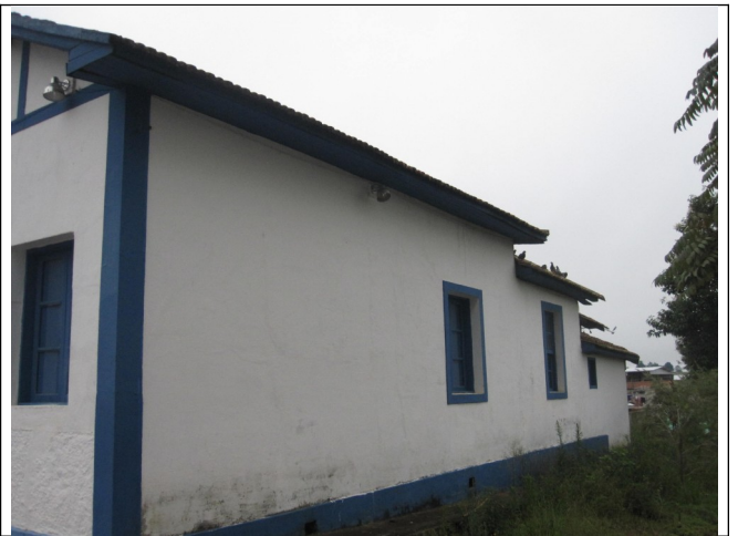
Figura 10 – Manchas de umidade junto a base.
