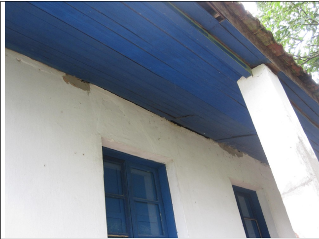
Figura 07 – Forro em mau estado de conservação.
