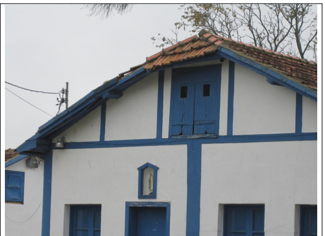
Figura 12 – Cobertura em mau estado de conservação.
