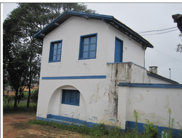
Figura 05 – Manchas de umidade na alvenaria.
