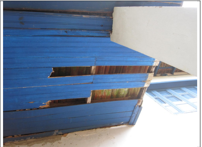
Figura 08 – Forro danificado e fungos nas telhas.
