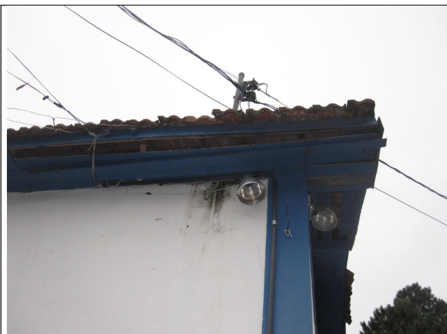
Figura 11 – Fiação precária junto a umidade.
