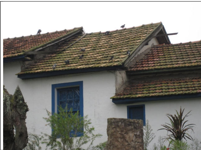
Figura 09 – Telhas comprometidas e pombos.
