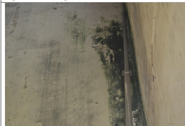
Figura 38 – Manchas de umidade.
