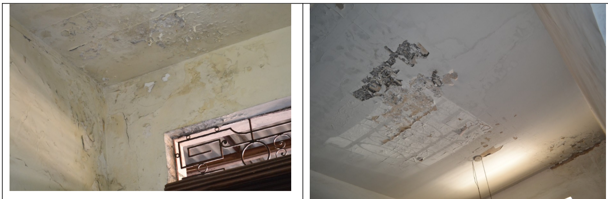
Figuras 08 e 09 – Infiltrações nas paredes e teto no espaço utilizado pela Associação de Deficientes.
