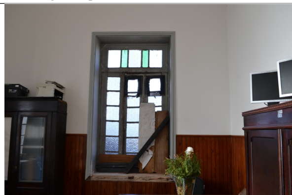
Figura 31 – Esquadrias muito danificadas.
