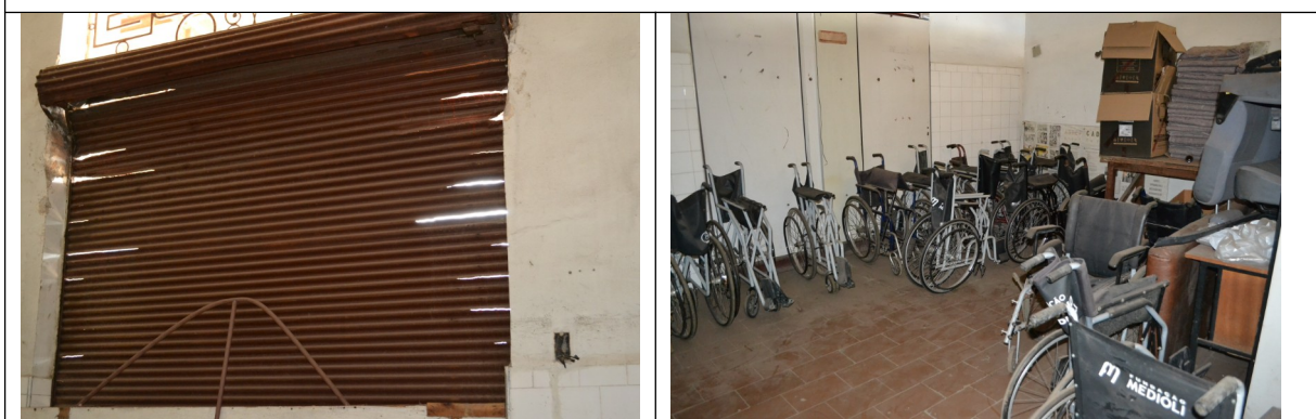
Figura 12 – Portas metálicas enferrujadas.
