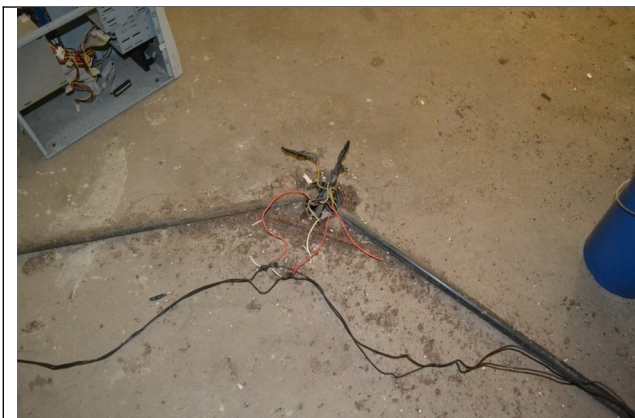
Figura 34 – Instalações elétricas precárias.
