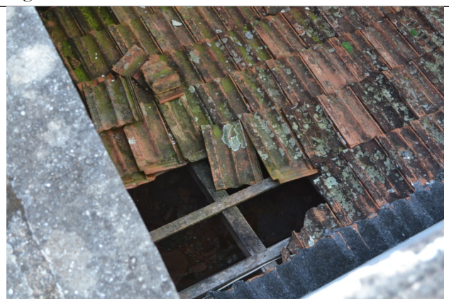
Figura 37 – Danos na cobertura.
