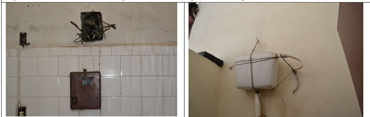
Figuras 10 e 11 – Instalações elétricas e hidráulicas precárias no espaço utilizado pela Associação de Deficientes.
