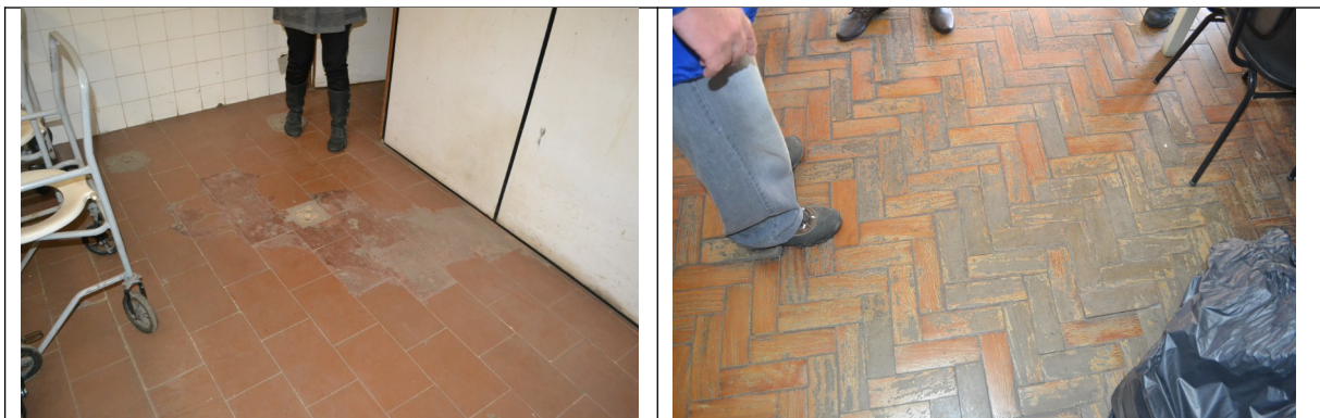
Figuras 14 e 15 – Lacunas e desgastes do piso no espaço utilizado pela Associação de Deficientes.
