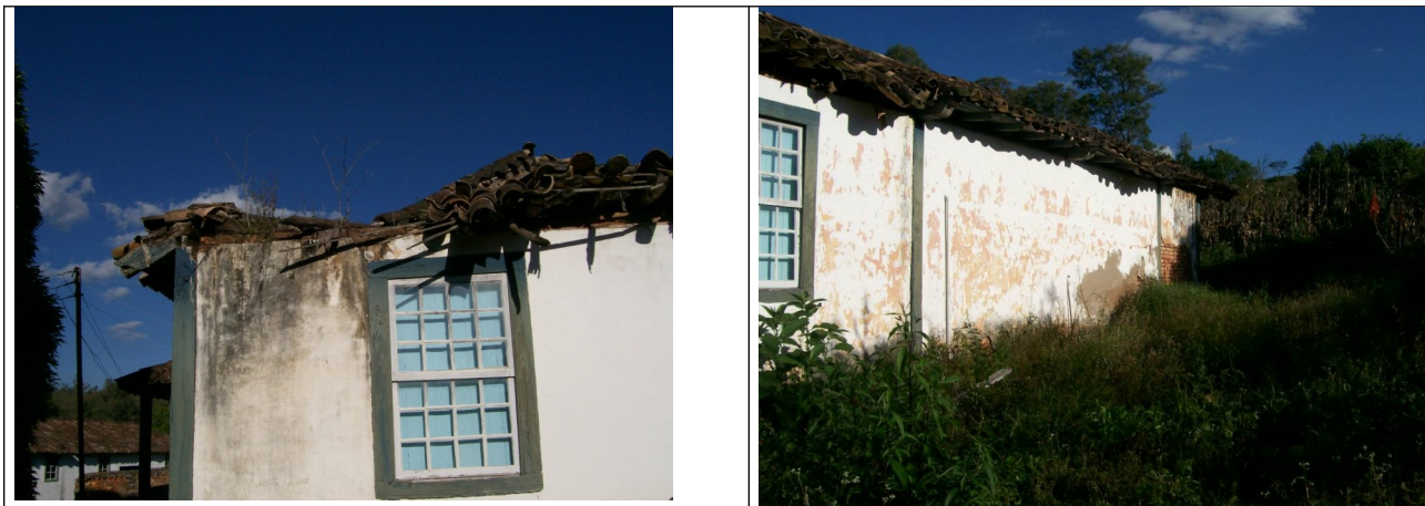
Figura 13 e 14 – Edificação em processo de arruinamento.
