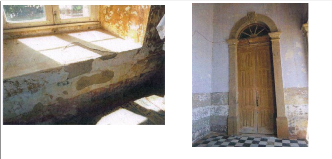
Figuras 6 e 7- Imagens internas da Igreja Matriz de São José das Três Ilhas, mostrando desprendimento de reboco em pontos da alvenaria e ressecamento da madeira das portas. Fonte: Relatório de Vistoria, IEPHA, 2015.
