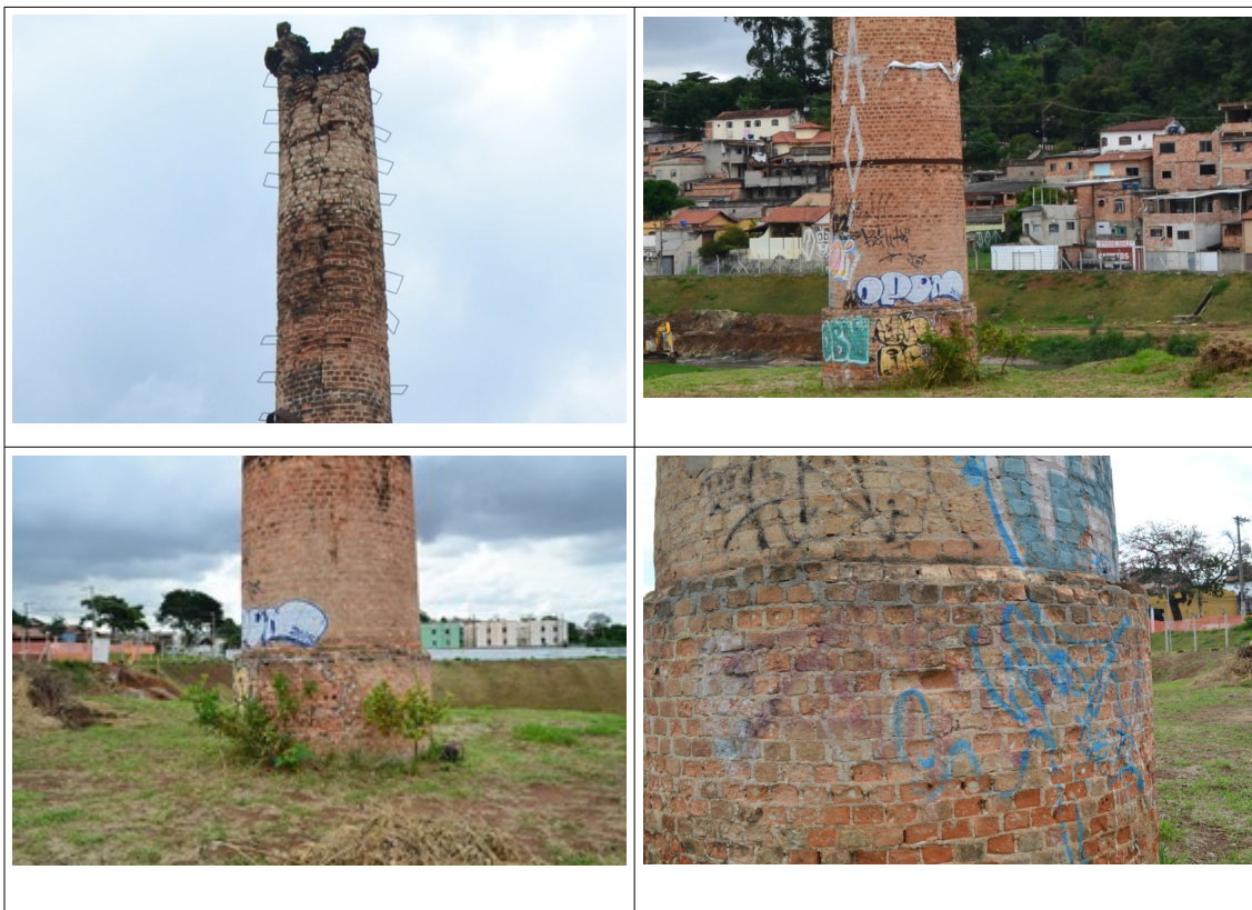
Figuras 12, 13, 14 e 15- Presença de rachaduras, trechos de desabamentos e pichações na Chaminé da Olaria. Fotos da visita ao local.
