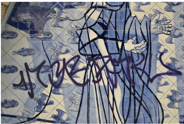
Figura 09 Detalhe pichação de nº 03.
