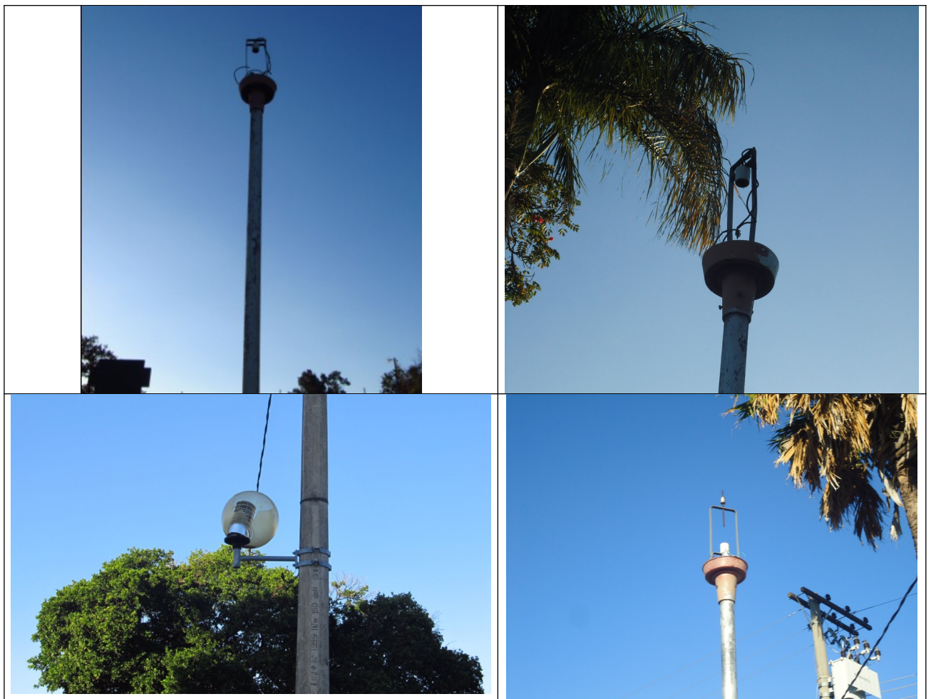
Figuras 01 a 04 – Imagens de luminárias comprometidas e sem lâmpadas.
