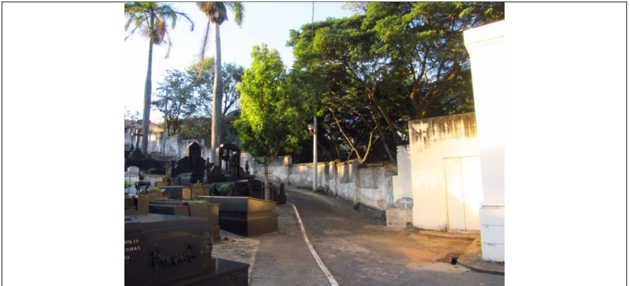
Figura 15 – Muro junto à rua Mariana na esquina com rua Sete Lagoas, sem elemento de proteção superior.
