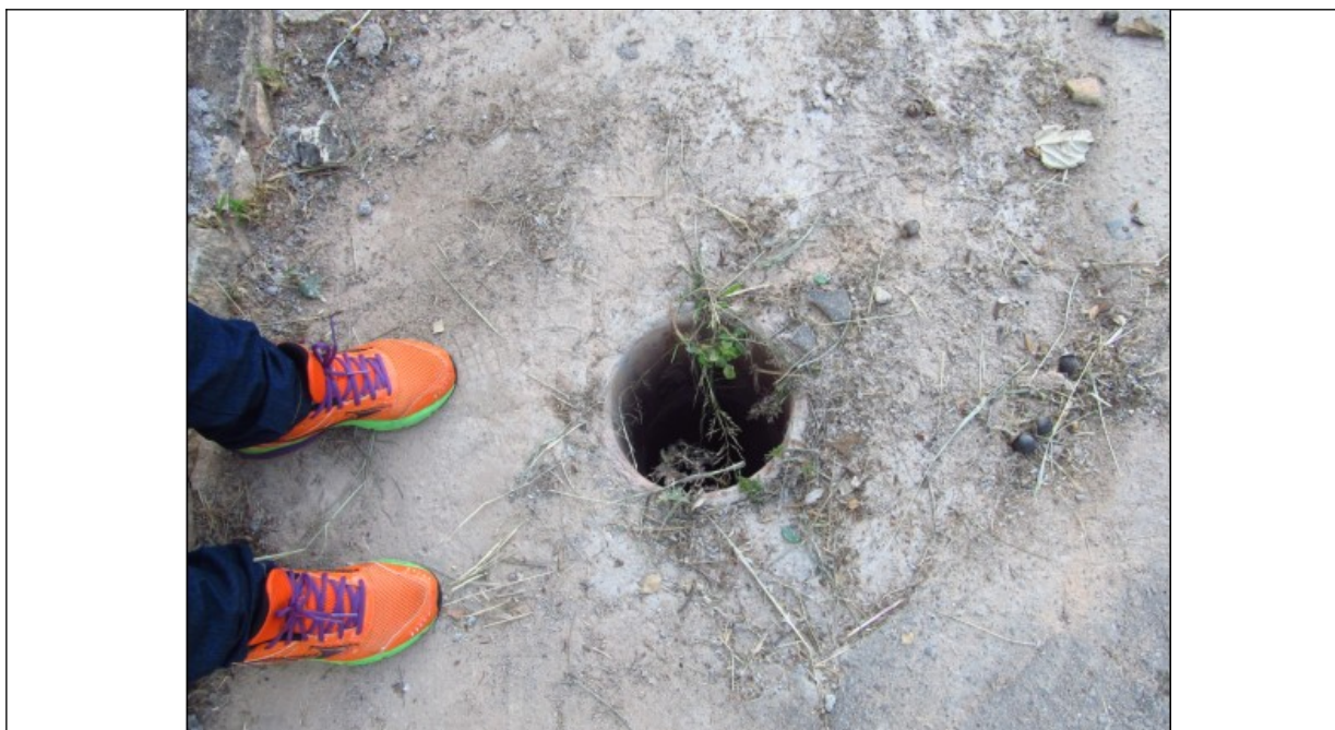
Figura 16 – Saída de água sem a devida proteção.
