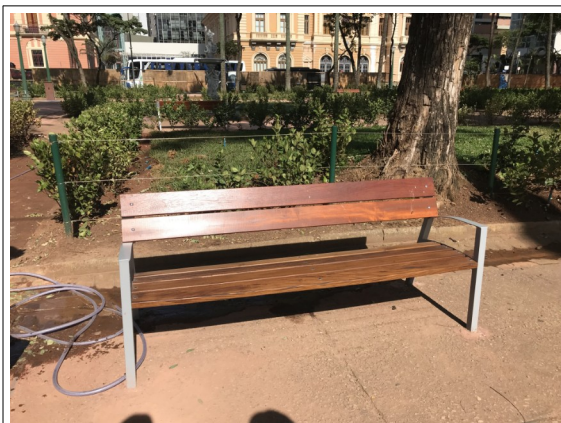
Figura 02 - Banco em novo modelo, similar ao anterior, instalado no local.
