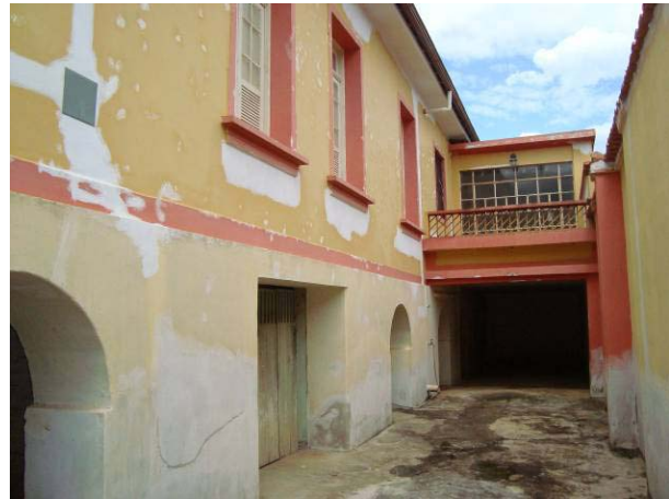
Vista do afastamento lateral esquerdo da edificação, bem como do acesso ao porão.
