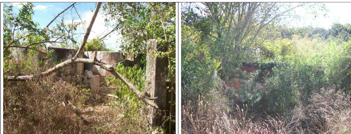
Figuras 03 a 04 – Cilos em estado de arruinamento. Apresentam-se atualmente tomados por vegetação em com várias estruturas danificadas, além da inexistência do antigo telhado.
