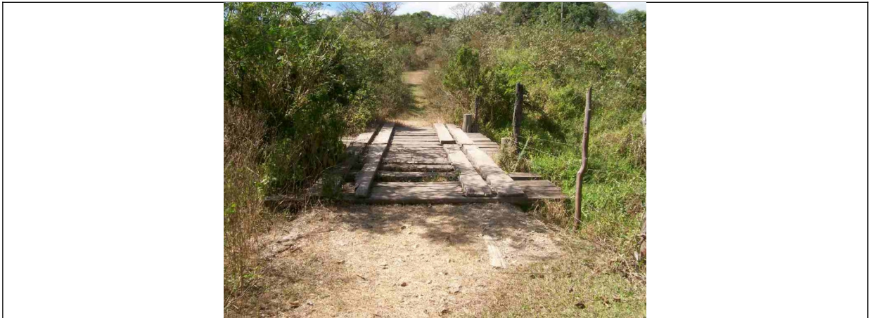
Figura 14 – Ponte em madeira sobre o córrego após a queda d'água
