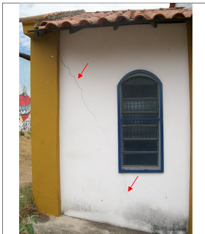
Figura 12 – Rachadura na parede lateral esquerda do edifício e mancha de infiltração ascendente na base.
