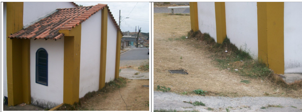
Figuras 10 e 11 – Ausência de calçamento e sistema de drenagem nos fundos da edificação.
