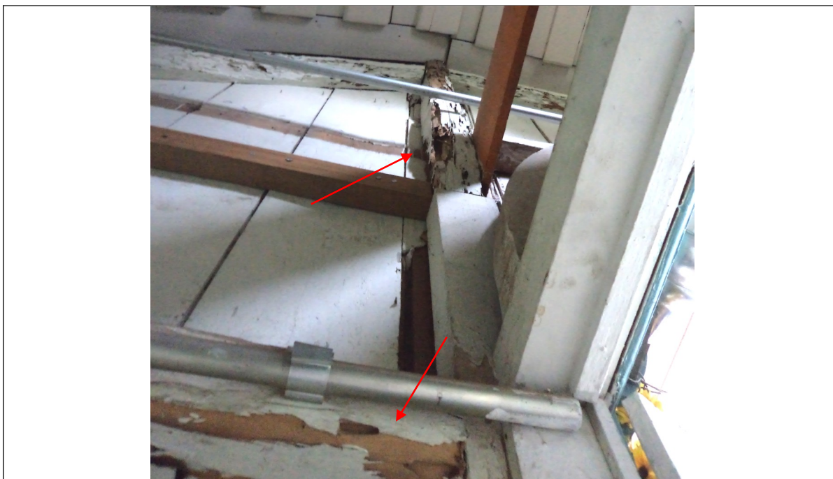
Figura 13 – Madeirame existente na parte posterior do retábulo, nota-se que estas peças de madeira encontram-se fragilizadas em diversos pontos. Fonte: CPPC.
