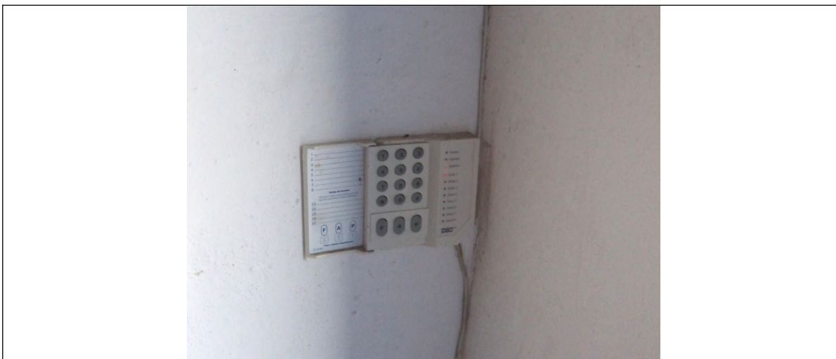
Figura 7 – Alarme de presença em funcionamento. Fonte: CPPC.
