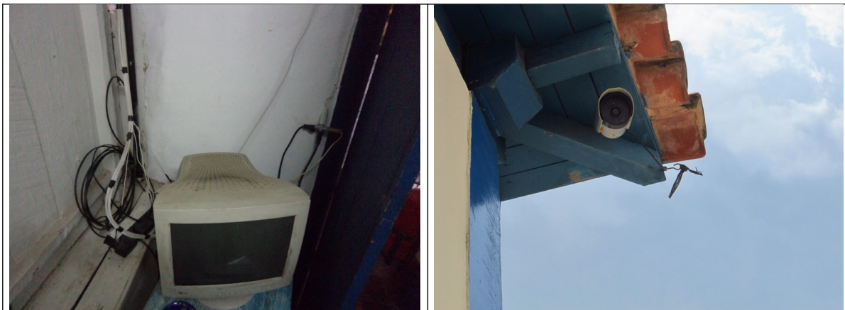
Figuras 5 e 6 – Verificou-se que o computador, aliado à câmera como ferramenta de monitoramento, encontram-se desligados, inoperantes. Fonte: CPPC.
