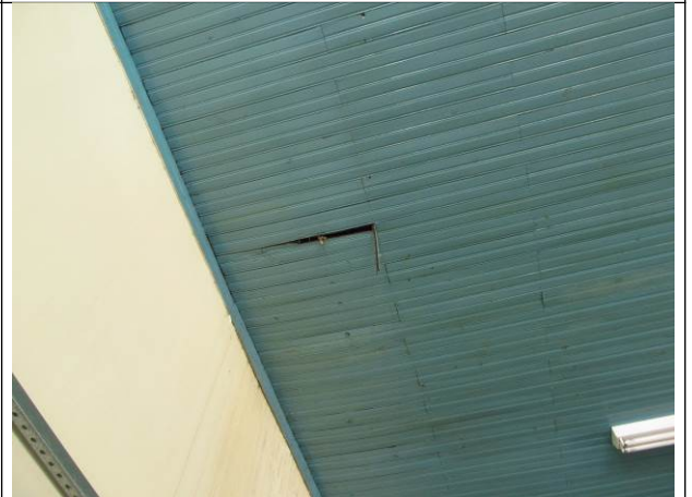
Figura 09 – Detalhe de patologia no forro em madeira. Foto: Neise Duarte, dez/2014.
