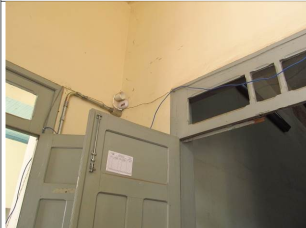
Figura 08 – Detalhe de fiação exposta. Foto: Neise Duarte, dez/2014.
