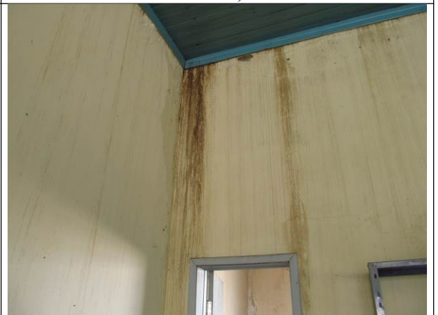
Figura 11 – Manchas de infiltração de água na alvenaria interna. Foto: Neise Duarte, dez/2014.
