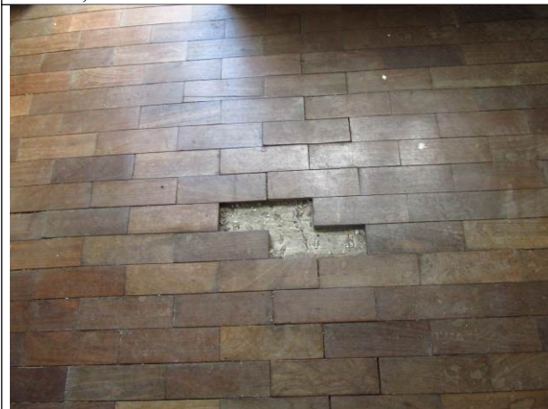
Figura 10 – Detalhe para perda de parte do piso em Foto: Neise Duarte, dez/2014.
