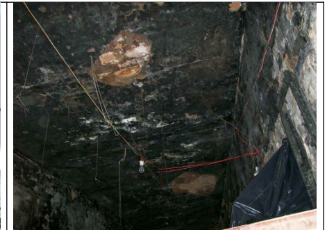
Figura 19 – Alvenarias chamuscadas e fiação aparente.
