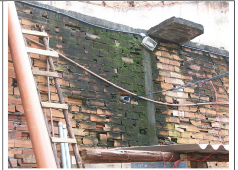
Figura 16 – Manchas de umidade, bolor e fiação aparente.
