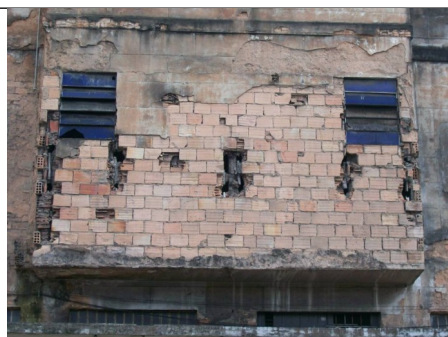
Figura 12 – Descolamento do reboco e lacunas nas alvenarias.
