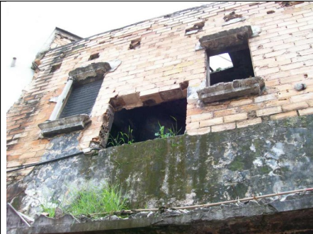
Figura 15 – Manchas de umidade, plantas invasoras e descolamento do reboco.
