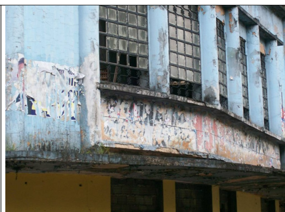
Figura 07 – Esquadrias com vidros quebrados e cartazes afixados nas alvenarias.
