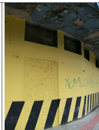
Figura 05 – Vãos fechados com alvenaria.
