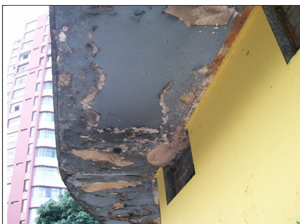
Figura 06 – Marquise com manchas de umidade e desprendimento da camada de tinta.
