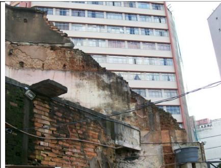
Figura 18 - Manchas de umidade, bolor e fiação aparente.
