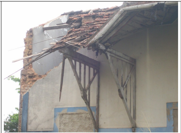
Figura 19 – Detalhe do trecho do telhado e da alvenaria que ruiu – fachada frontal.
