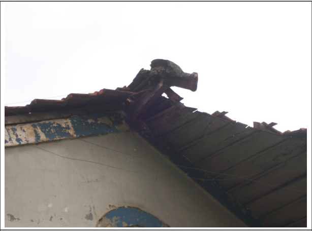
Figura 25 – Detalhe do telhado – arruinação da cumeeira e forro.
