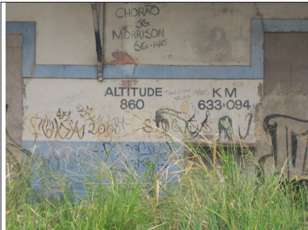
Figura 18 – Detalhe das pichações no edifício
