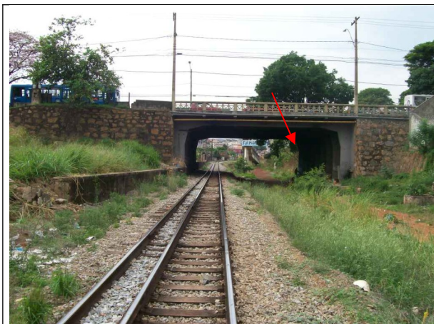
Figura 10 – Vista para o Viaduto da Av. Amazonas com ocupação irregular (indicada pela seta vermelha)
