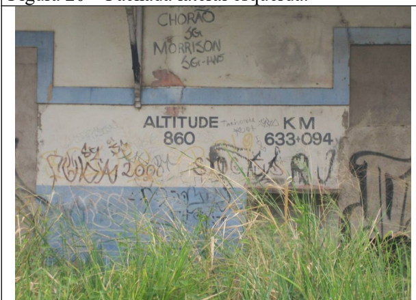
Figura 22 – Detalhe das pichações no edifício
