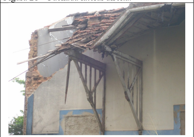
Figura 23 – Detalhe do trecho do telhado e da alvenaria que ruiu – fachada frontal.
