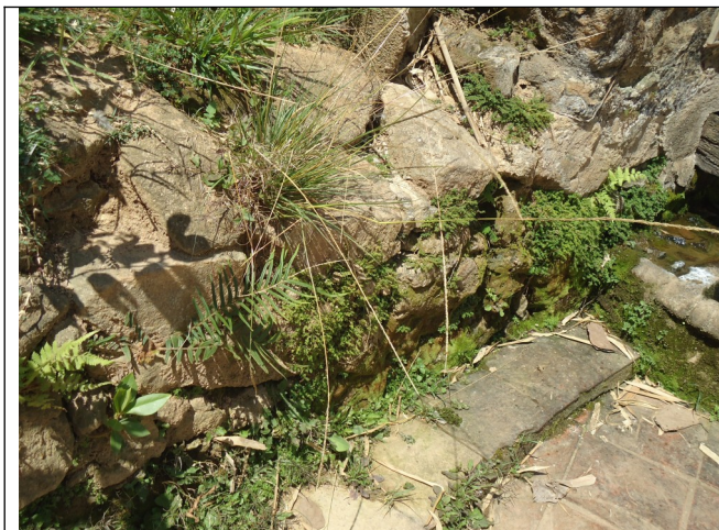
Figura 26 – Muro de pedras em processo de arruinamento.
