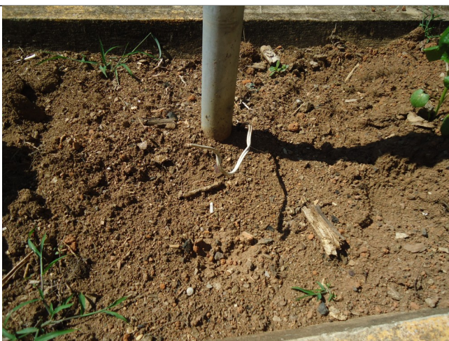
Figura 29 – Fiação elétrica cortada.
