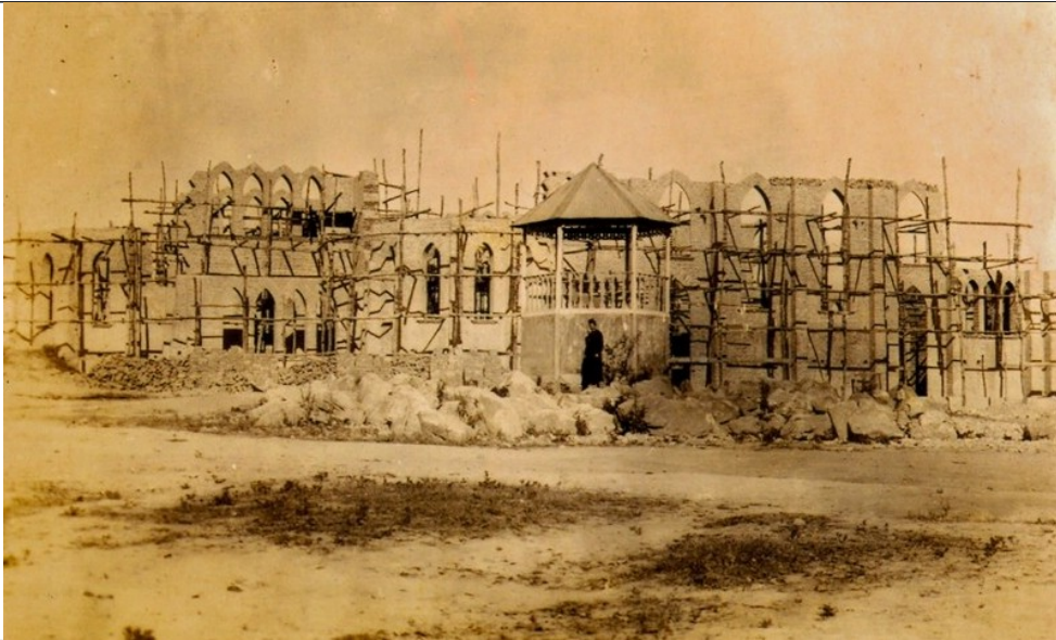
Figura 06- Construção da atual Matriz de N. Sra. do Bom Despacho em 1927. Fonte: http://www.senhoradosol.com.br/fotos_locais.php . Acesso 01-08-2013.
