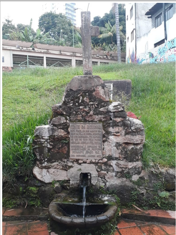
Figura 08 - Fonte que necessita de intervenções de restauro.
