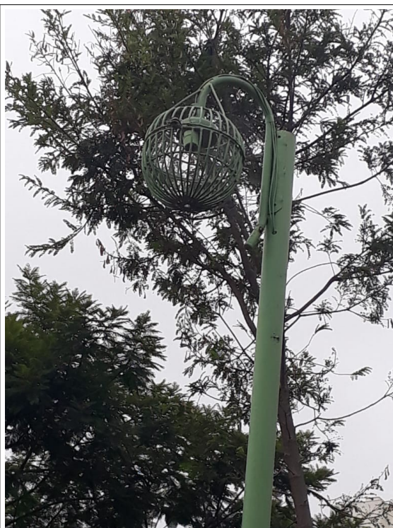
Figura 04 - Poste danificado e sem lâmpada.
