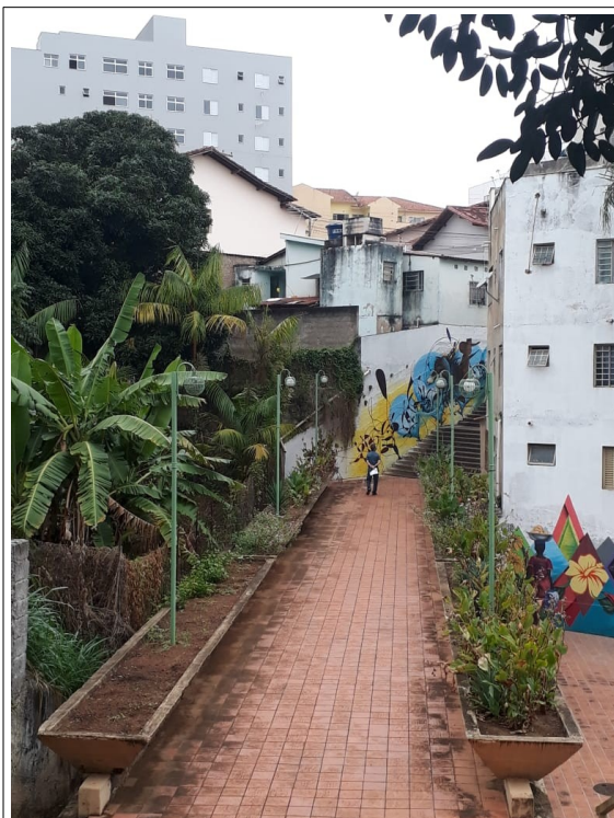
Figura 03 - Canteiros desprovidos de vegetação e sujeiras aderidas no piso cerâmico.
