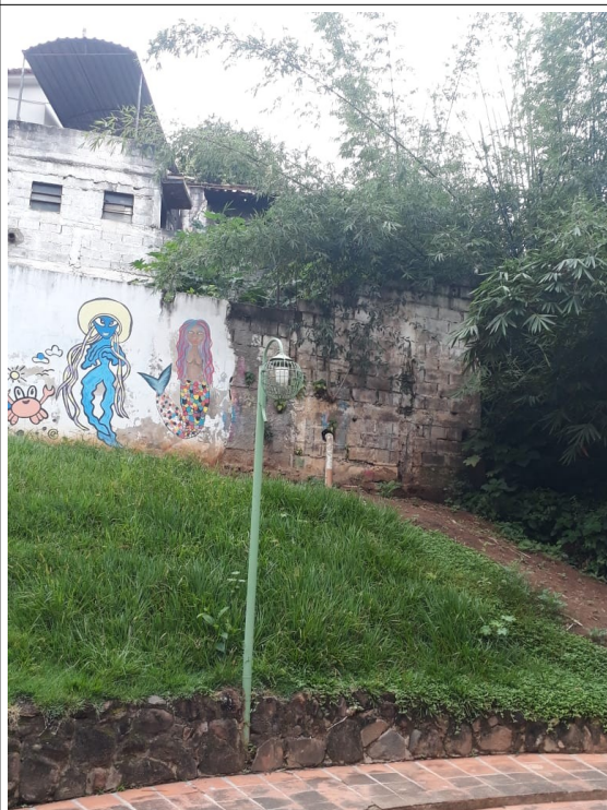
Figura 06 - Falhas na vegetação rasteira e muro sem pintura.
