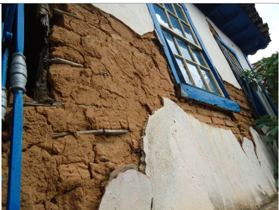
Figura 07 – Descolamento do reboco.
