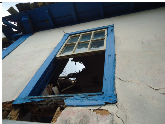
Figura 09 – Trincas e desfazimento do sistema construtivo.
