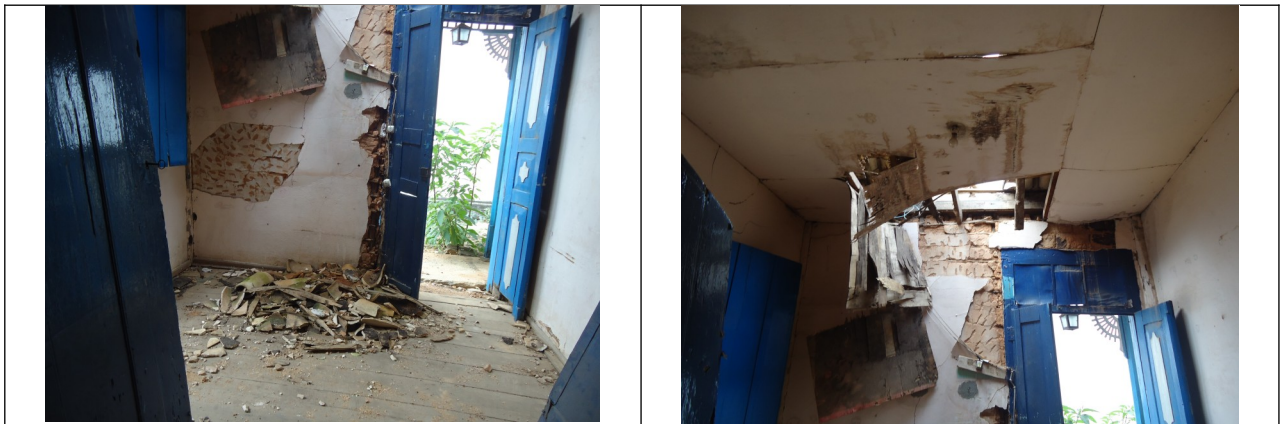
Figuras 11 e 12 – Cobertura em processo de arruinação
